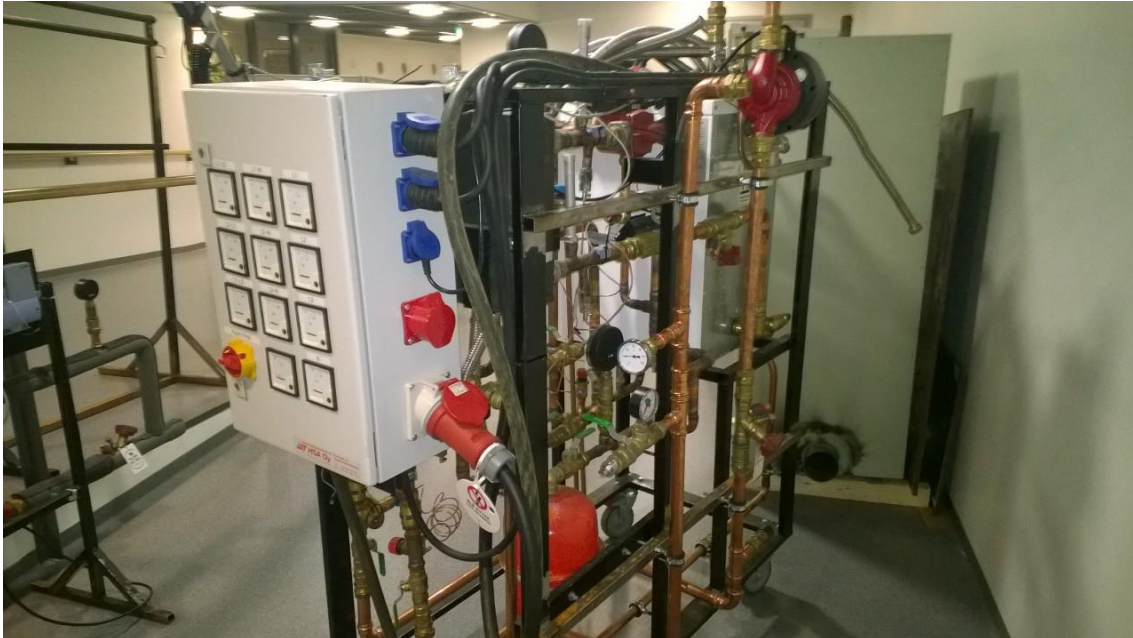
KUVA 4. Varauslaitteisto; kuvan yläosassa näkyy valittu Grundfos Magna 32-100 -pumppu
