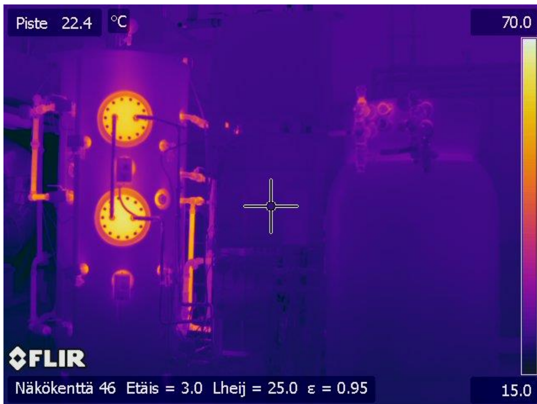
KUVA 9. Muovivaraaja oikealla ja saneerausvaraaja vasemmalla
