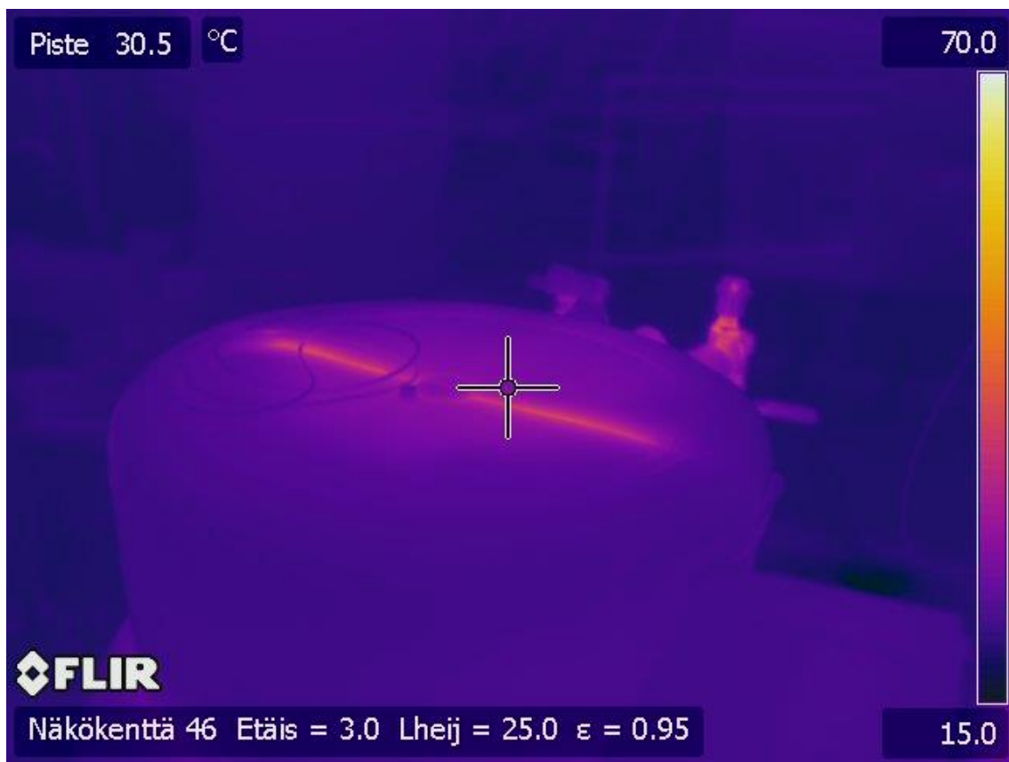
KUVA 10. Muovivaraajan hattu päältäpäin
