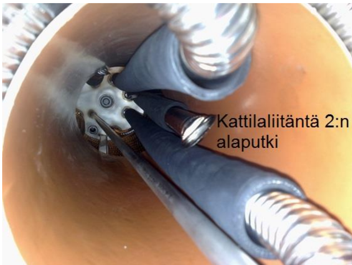
KUVA 3. Tulpattu kattilaliitäntä; putken kyljessä näkyy pientä reiitystä
