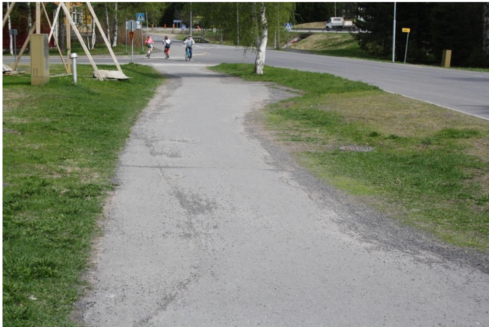
Kuva 28. Heikosti harjattu kevyen liikenteen väylä 21.5 Kiimingissä Siltatiellä.
