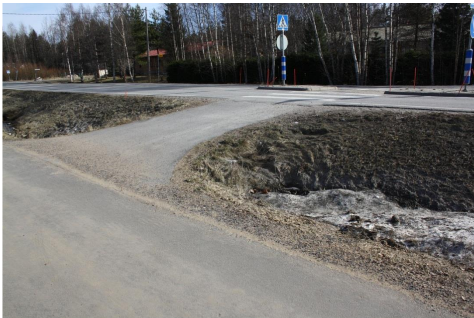
Kuva 18. Oulunsalossa Lummintien päässä ELY-keskuksen ja Oulun kaupungin hoitorajalle pisteen 6 kohdalle jäänyt harjaamaton rajakohta.
