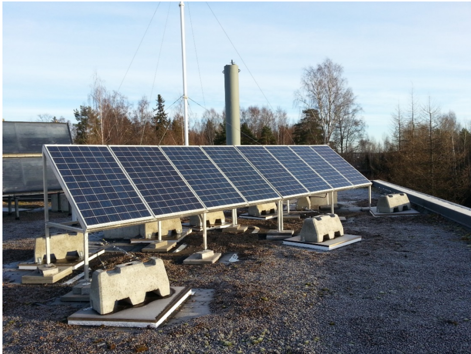
KUVA 8. Aurinkopaneelit asennettuna telineisiin
