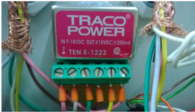
KUVA 17. TRACO POWER DC/DC -piiri logiikkalaatikossa
