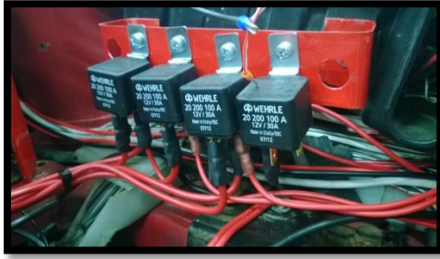
KUVA 25. Pumppuja ohjaavat releet
