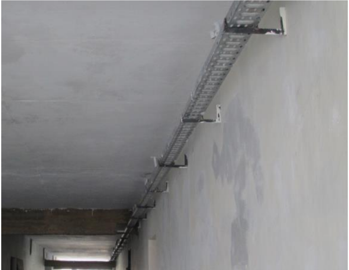
Kuva 10. Käytävän kattoon asennettu kaapelihylly.
