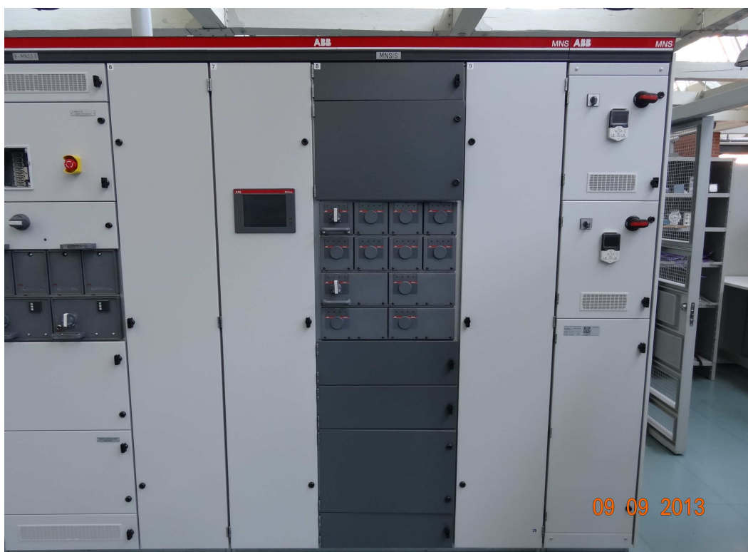
Kuva 11. MNS iS-kojeiston kasettikenttä kuiluineen
