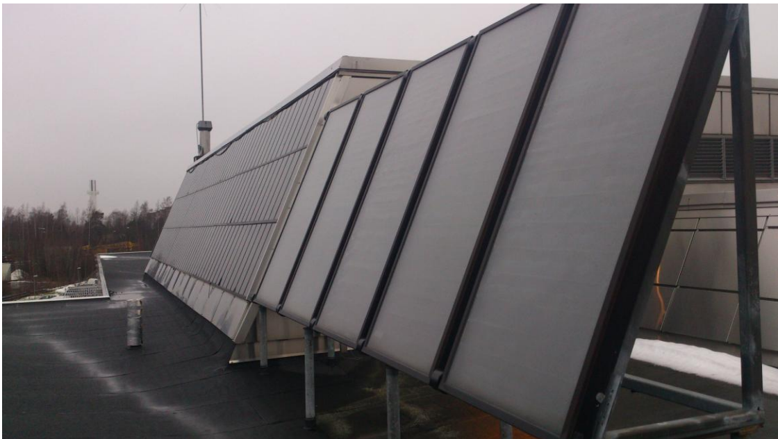
KUVA 4. Katolle asennetut aurinkokennot ja osa aurinkokeräimistä
