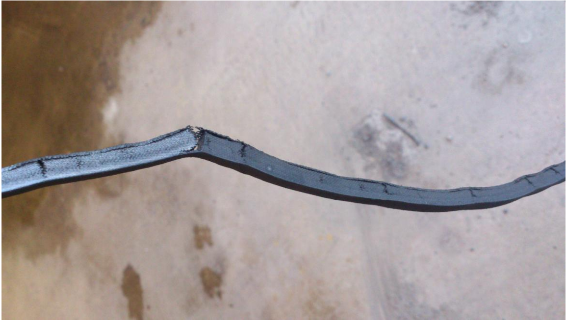
KUVA 7. Rispaantunut ja lähes katkennut TK306:n puhaltimen hihna
