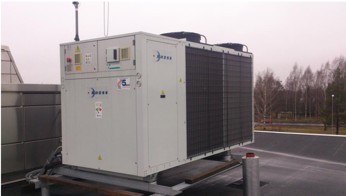
KUVA 2. Katolle asennettu kylmäkone
