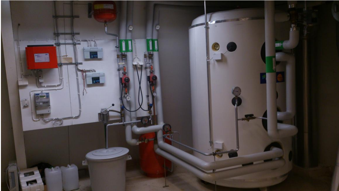
KUVA 3. Aurinkolämpöjärjestelmän nestevaraaja ja kiertopumput sekä aurinkosähköjärjestelmä
