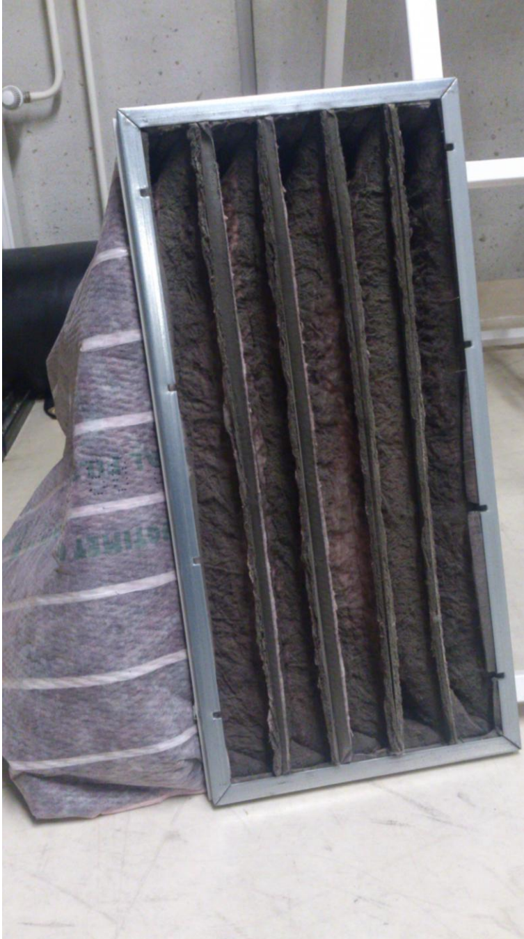
KUVA 9. TK305:n hyvin likainen suodatin
