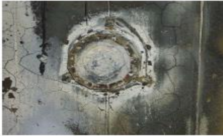
Kuva 5. Palonsuojamansetti on tiivistänyt sulaneeseen muoviputkeen syntyneen aukon. (Palokatko-opas 2014)
