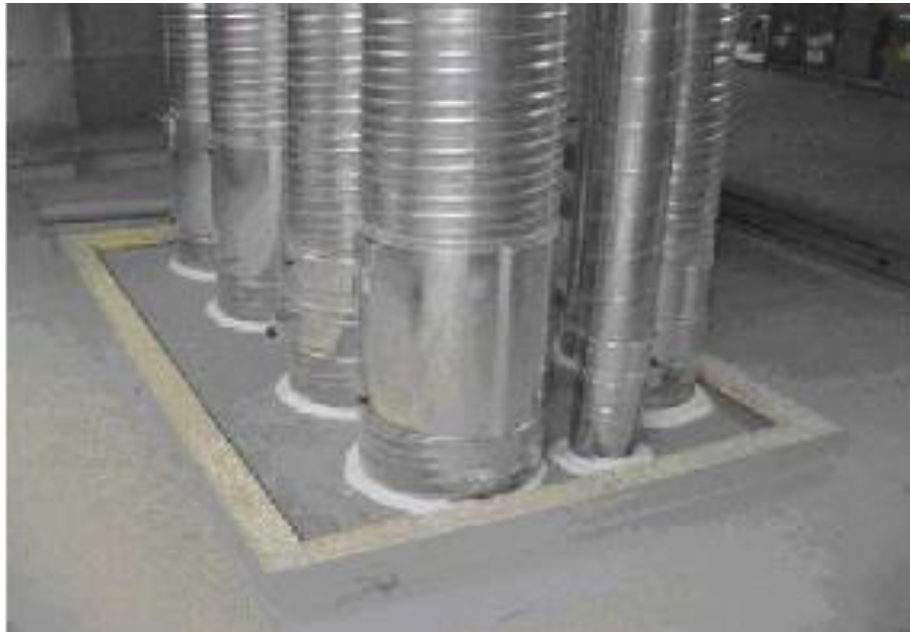
Kuva 11. Katon tai lattian läpivientien huolellinen tiivistäminen estää palon leviämisen palo-osastosta toiseen yhdessä muiden paloturvallisuustoimien kanssa. (Palokatko-opas 2014)
