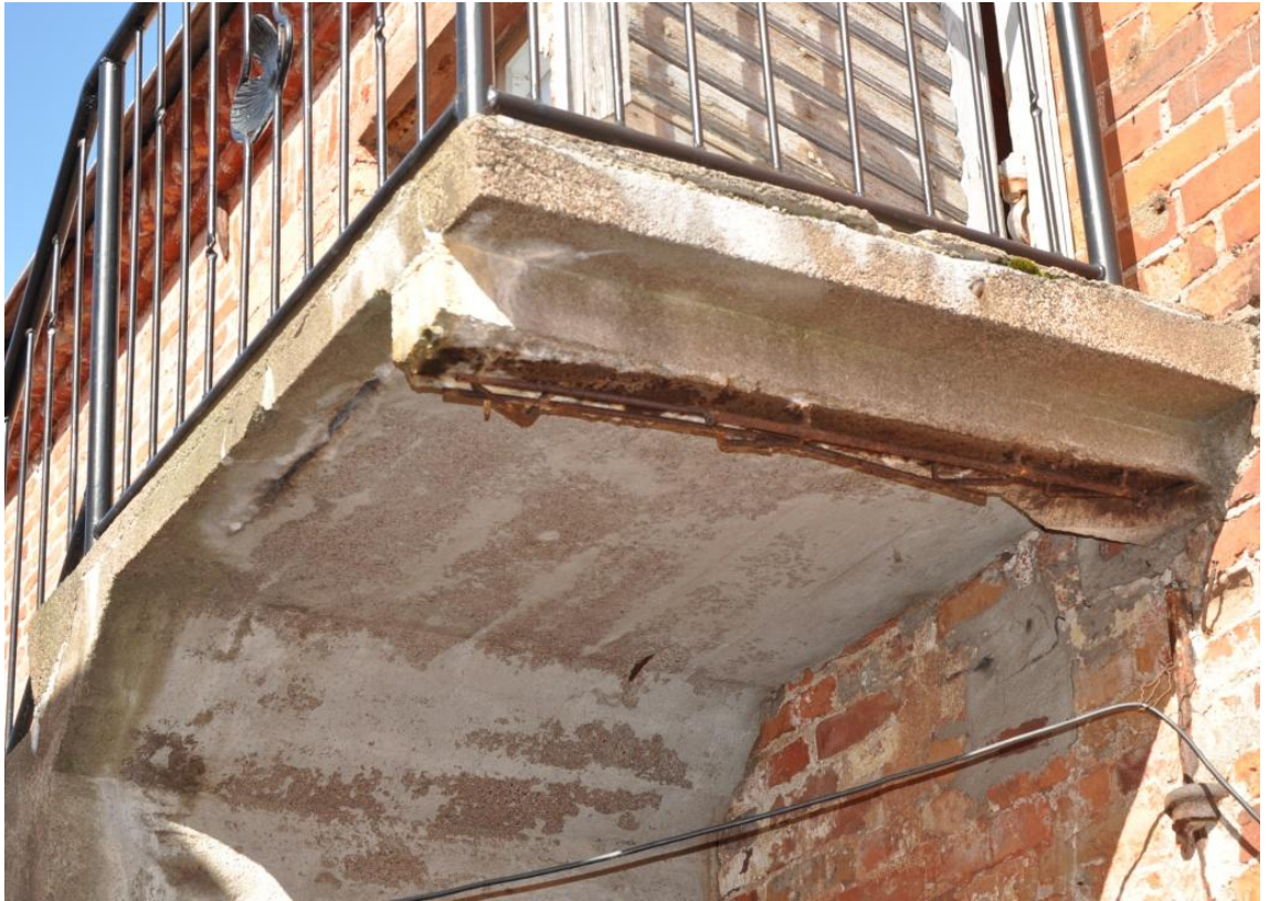
Kuva 10. Pajarakennuksen portaiden vaurioitunut betoni
