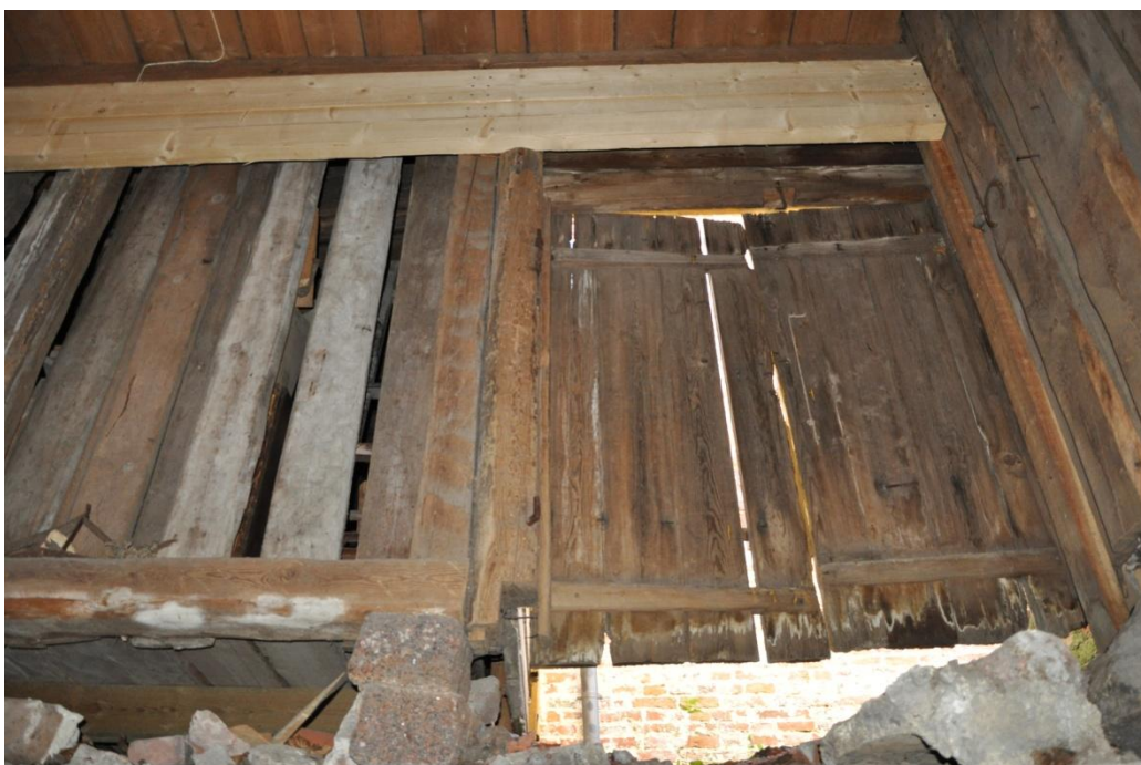
Kuva 6. Romahtaneen kellarin ovet. Kuvan yläreunassa näkyy tukipalkki, jolla pyritään estämään lisävahinkoja.
