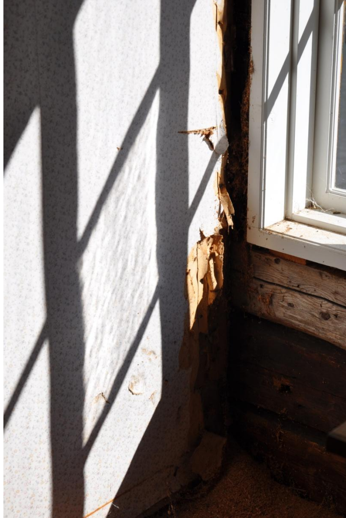
Kuva 13. Ajurin asunnon nurkka. Mitä tässä on tapahtunut? Onko laho mahdollisesti levinnyt väliseinän puolelle?
