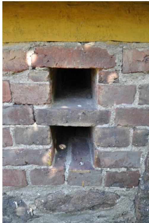
Kuva 20. Pienet tukkimattomat kolot Mattilan kivijalassa
