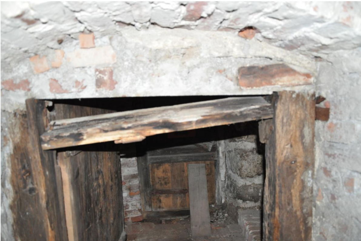
Kuva 23. Kellari. Muutamat laudat ovat vaihdon tarpeessa.
