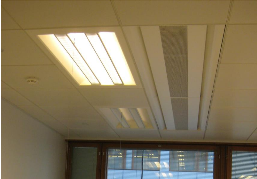
KUVA 14. PK2 -kiinteistön Halton CCC -jäähdytyspalkit ovat integroituina avotoimiston alaslaskettuun kattoon.
