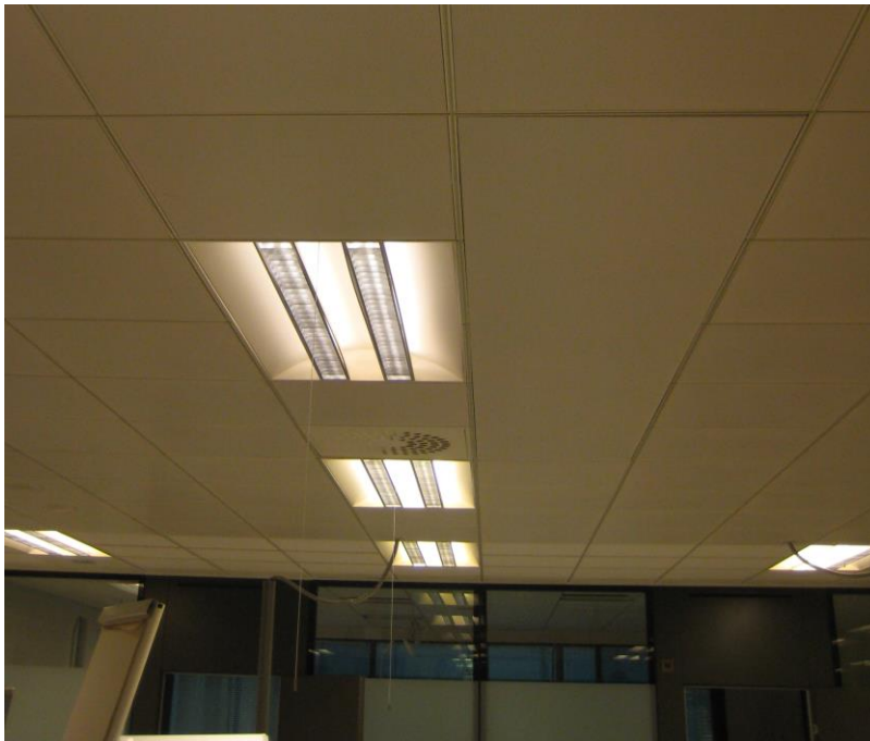
KUVA 13. PK1 -kiinteistössä Zehnder Carboline -jäähdytyspaneelit ovat integroituina alaslaskettuun kattoon.
