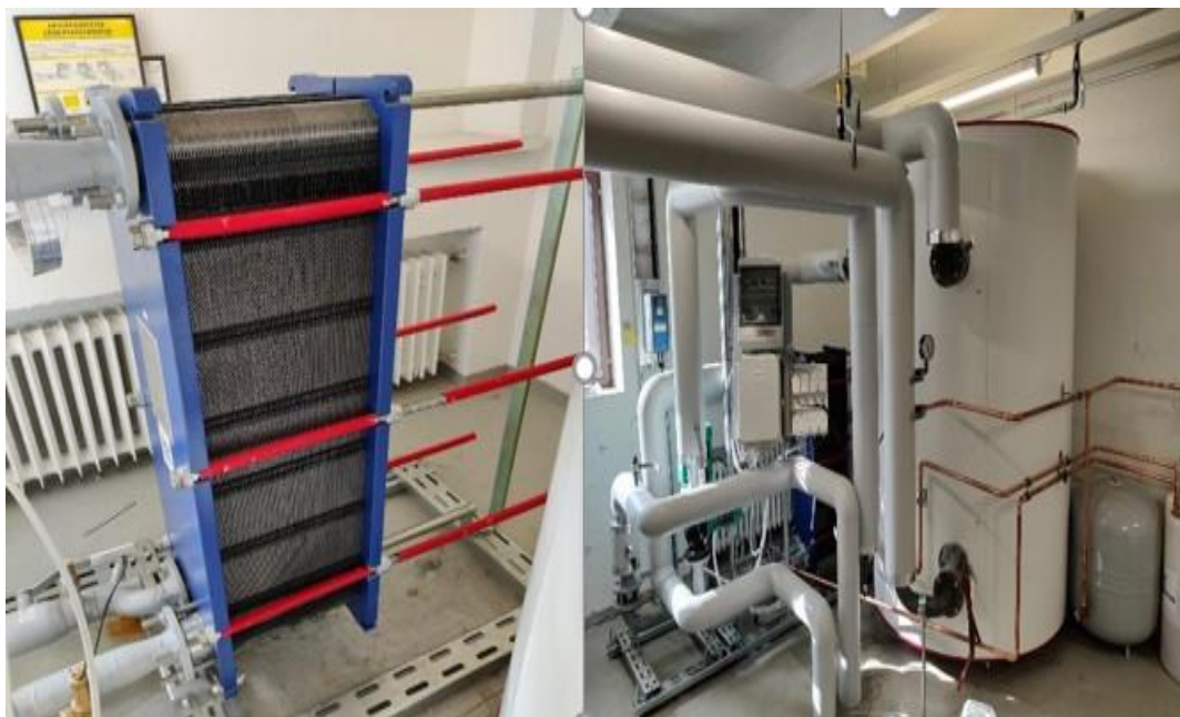
KUVA 20. Lämmönsiirrin ja aurinkolämpökentän lämmönvaraaja (Karjalainen 2021)
