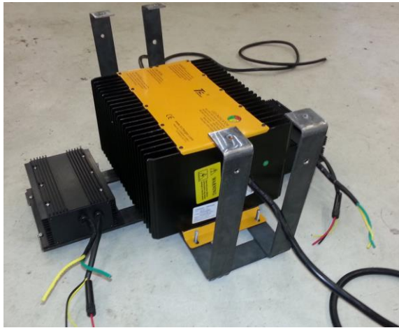
KUVA 37. Vararengaan syvennykseen asennettu laturi ja DC/DC muuntimet
