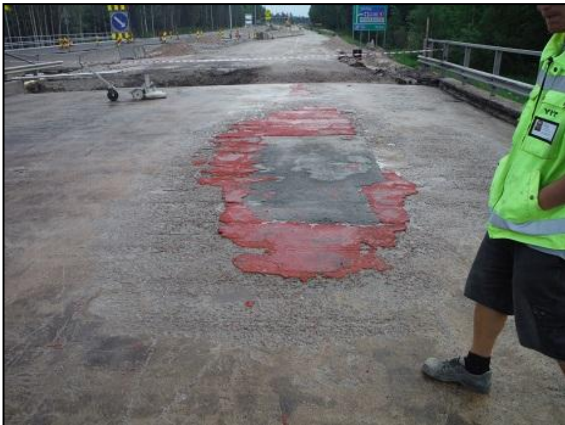
KUVA 34. Vanhoja korjauksia ja bitumijäämiä tasovesipiikkauksen jäljiltä (Tarvainen 2013-06-06)
