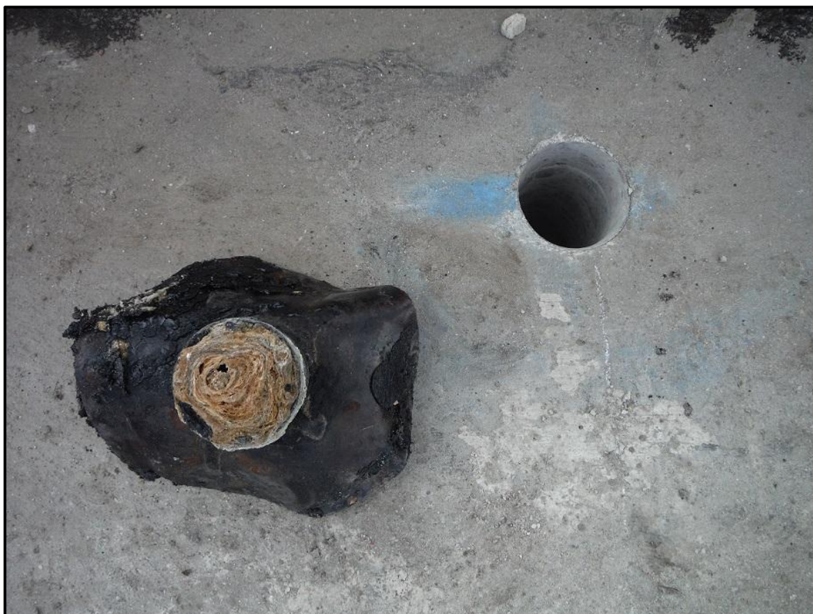
KUVA 13. Vanha tukkiintunut tippuputken lautanen ja uusi reikä porattuna (Tarvainen 2013-06-06)
