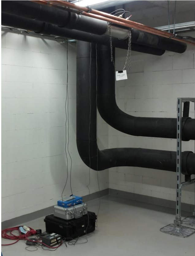
Kuva 10. Ultraäänivirtausmittari ja lämpötilamittari asennettuna alueensulanapitojärjestelmän jakojohdossa tallentamaan automaattisesti mittaustuloksia.
