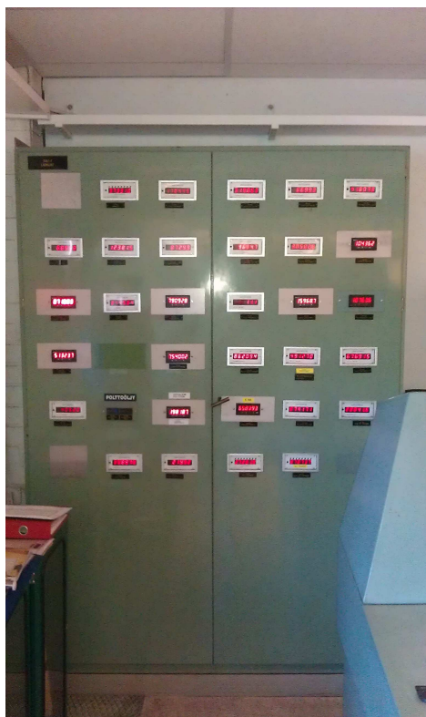
KUVA 1. Laskuriseinä valvomossa. (Valokuva Antti Turunen 2013.)
