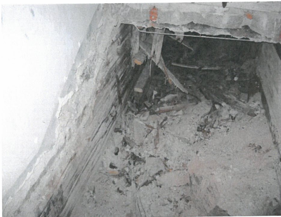
Kuva 6. Portaan alta on esiin tullut purkamaton muottilauditus. Valvojan valokuva
