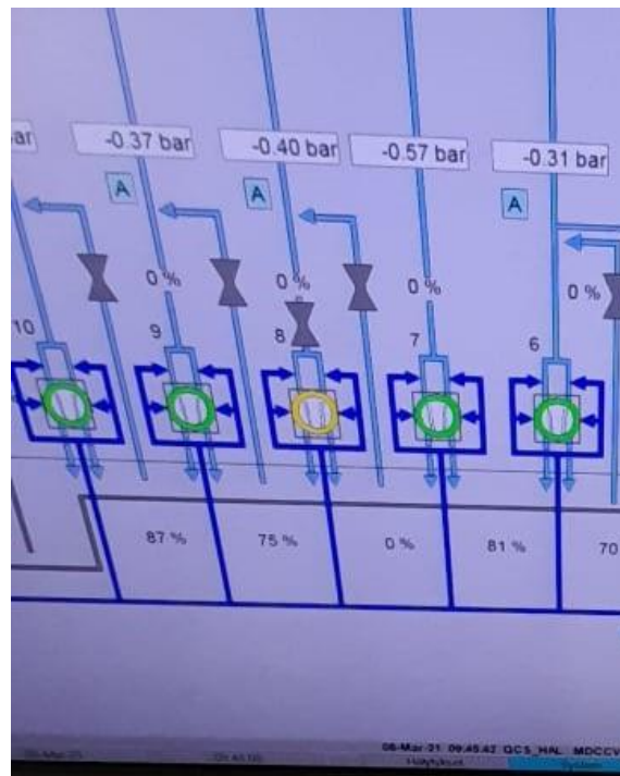
Kuva 53. Tyhjiöpumppu 10 87 % kuormalla ja 79.74 % teholla
