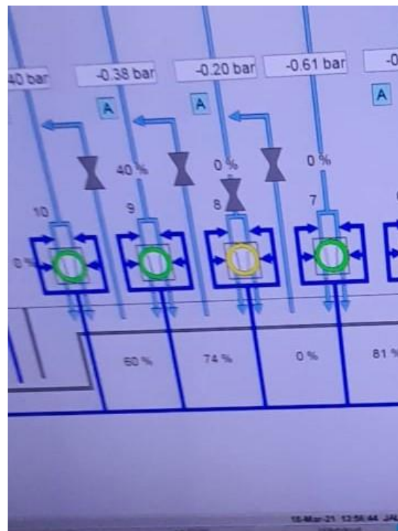
Kuva 54. Tyhjiöpumppu 10 60 % kuormaa ja 34.89 % teholla
