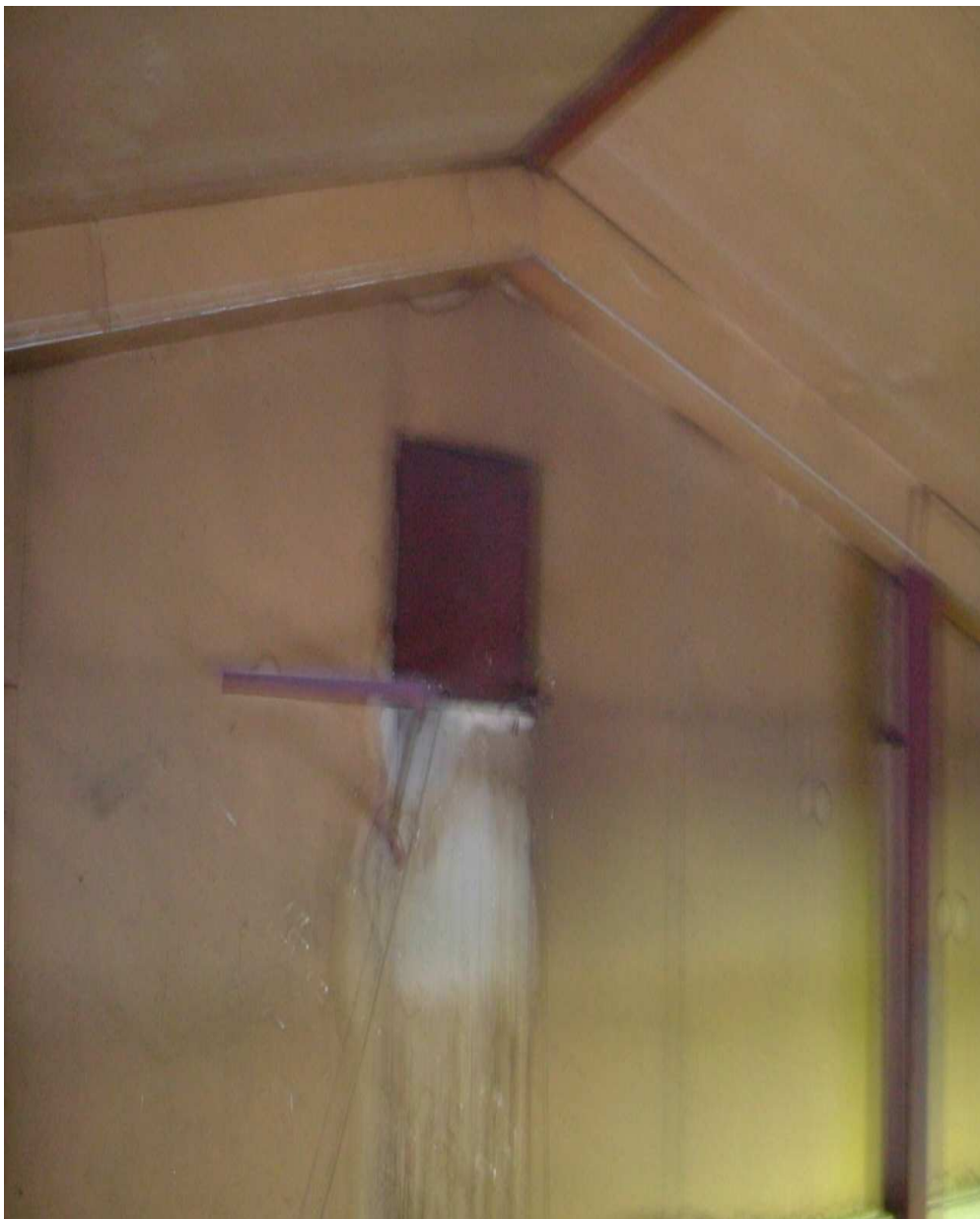
Kuva 5. Hallin seinässä näkyviä homevaurioita
