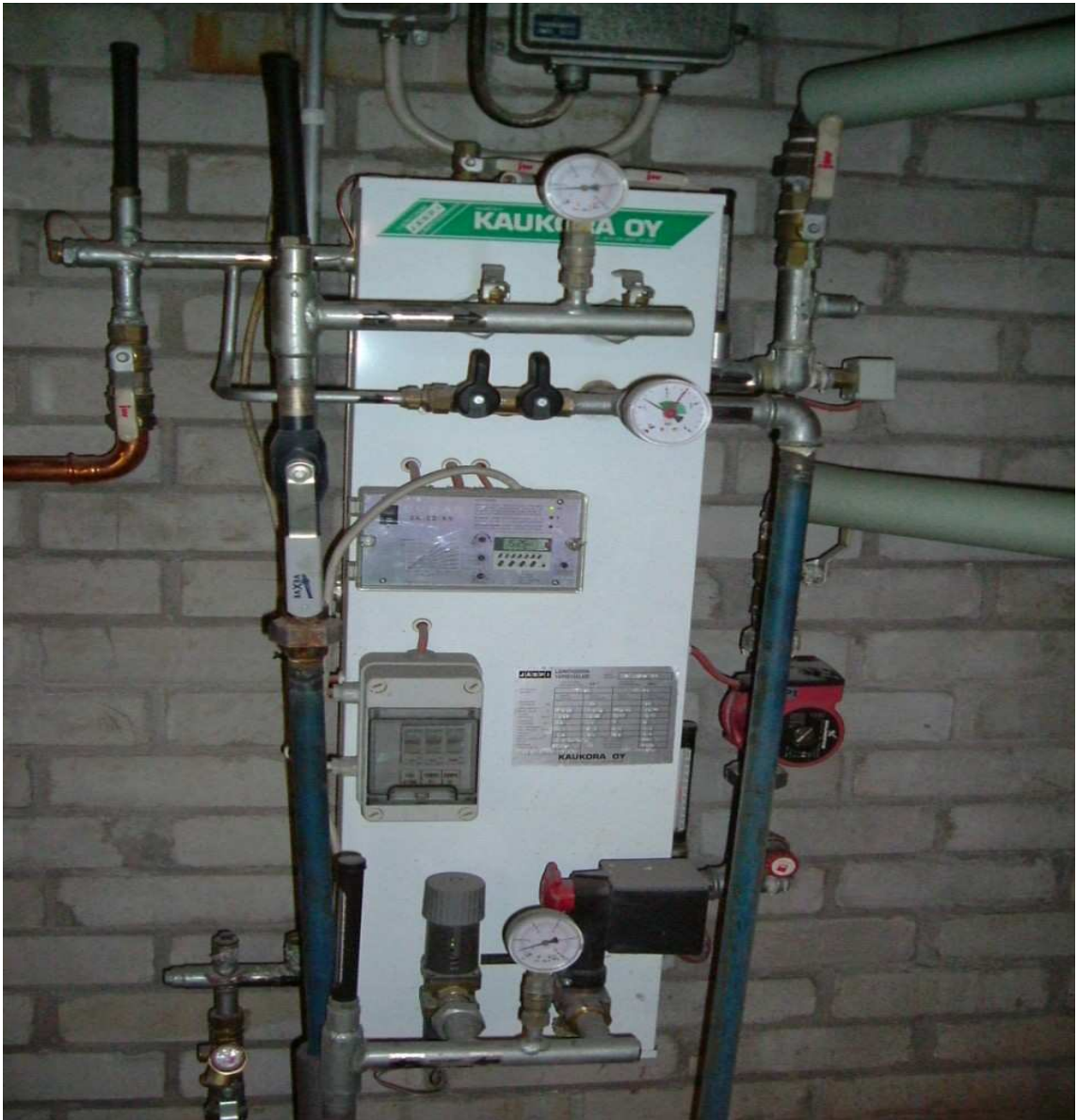
Kuva 4. Uusittu lämmönsiirrin Kaukora Jäspi
