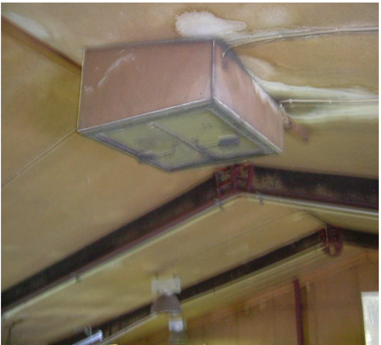
Kuva 3. Huippuimuri hallin katossa
