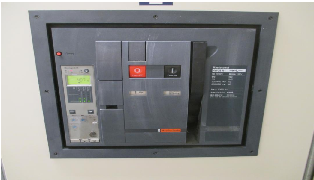
KUVA 7. Pääkeskuksen pääkatkaisija ja elektroninen suojarile
