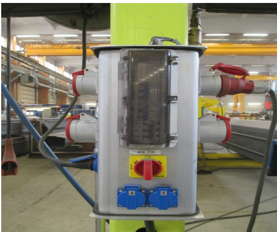
Kuva 9. Hitsaamon työpisteen energiatolppaan sijoitettu 35 A:n pistorasiakeskus
