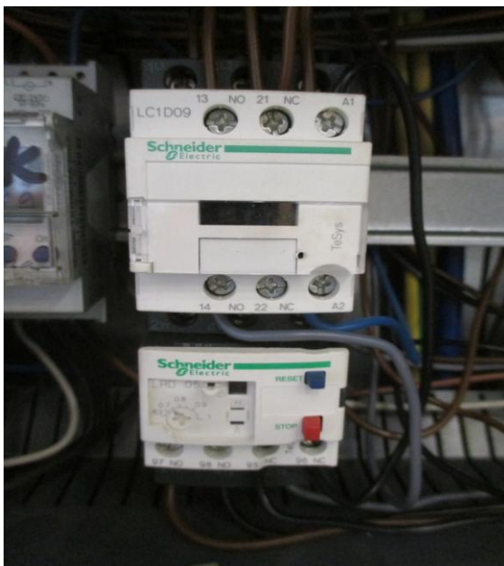
Kuva 8. Kuva JK11 kontaktorista ja siihen liitetystä lämpöreleestä
