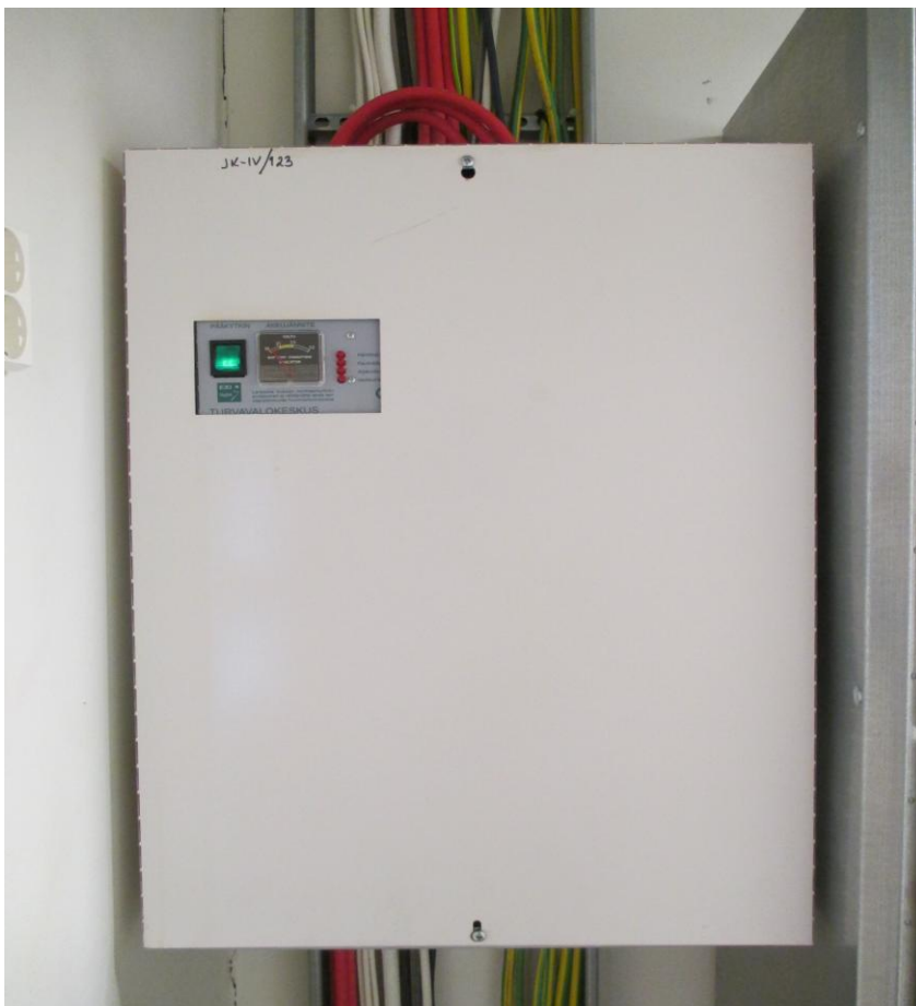
Kuva 4. Kiinteistön Exilight turvavalaistuskeskus
