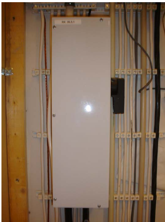
Kuva 2. RK26.3.1 olevasta erillisestä kotelosta
