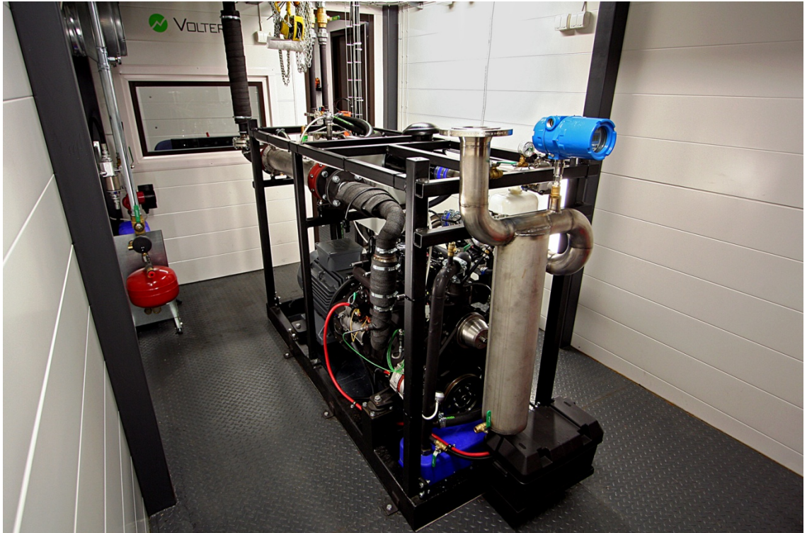
Kuva 4. Volter Oy:n toimittama kaasumoottori ja generaattoriyksikkö (Volter Oy 2013)
