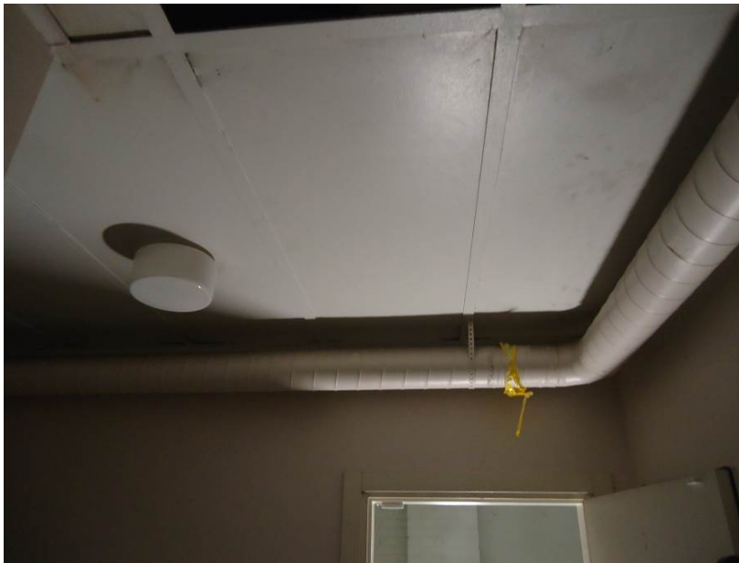
Kuva 10. Asbestiruiskutettu kanava on eristetty huoneesta alas lasketulla katolla, joka muodostuu metallirungosta ja asbestisementtisistä Luja-levyistä
