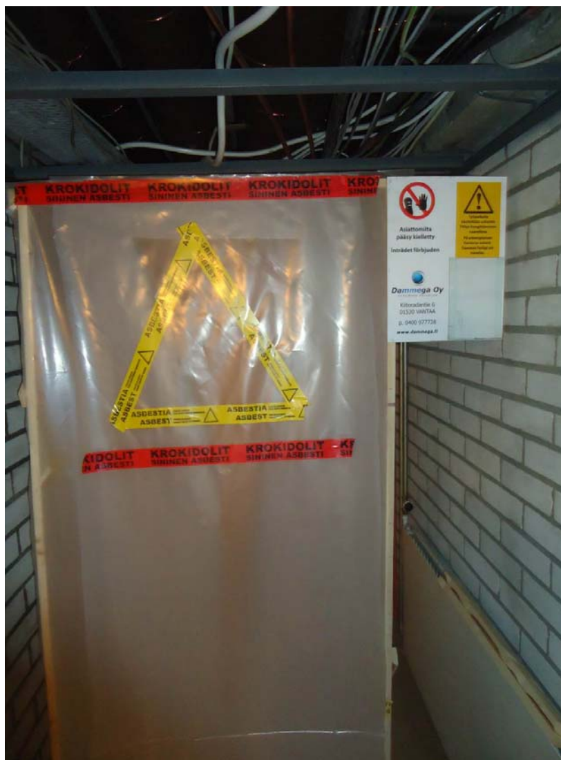
Kuva 19. Sulkutunneliin liitetystä kilvestä selviää asbestipurkuryityksen nimi sekä pakolliset varoitustekstit. Kilvessä on tasku, johon voi laittaa asbestipurkusuunnitelman.
