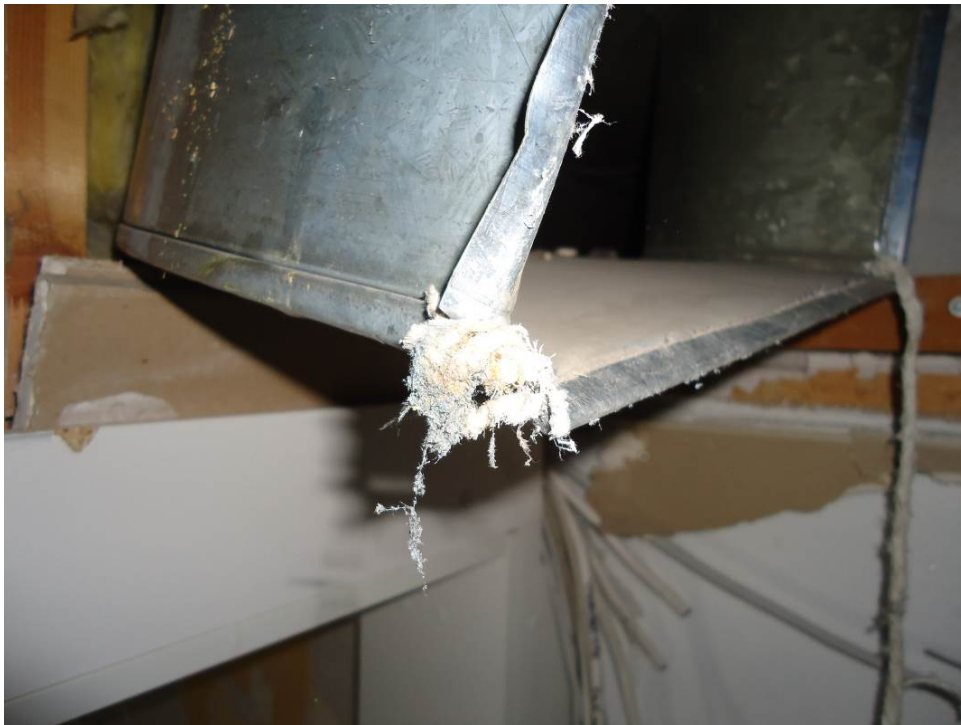
Kuva 11. Asbestinarua ilmastointikanavan liitoksessa
