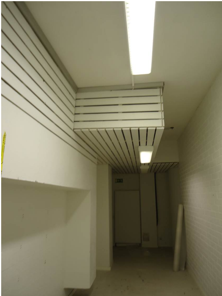
Kuva 25. Vanhan parturi-kampaamon harvalaudoitus alakaton/koteloiden yläpuolella on krokidoliittiasbestia, joka on irrottanut asbestikuituja tilan ilmaan
