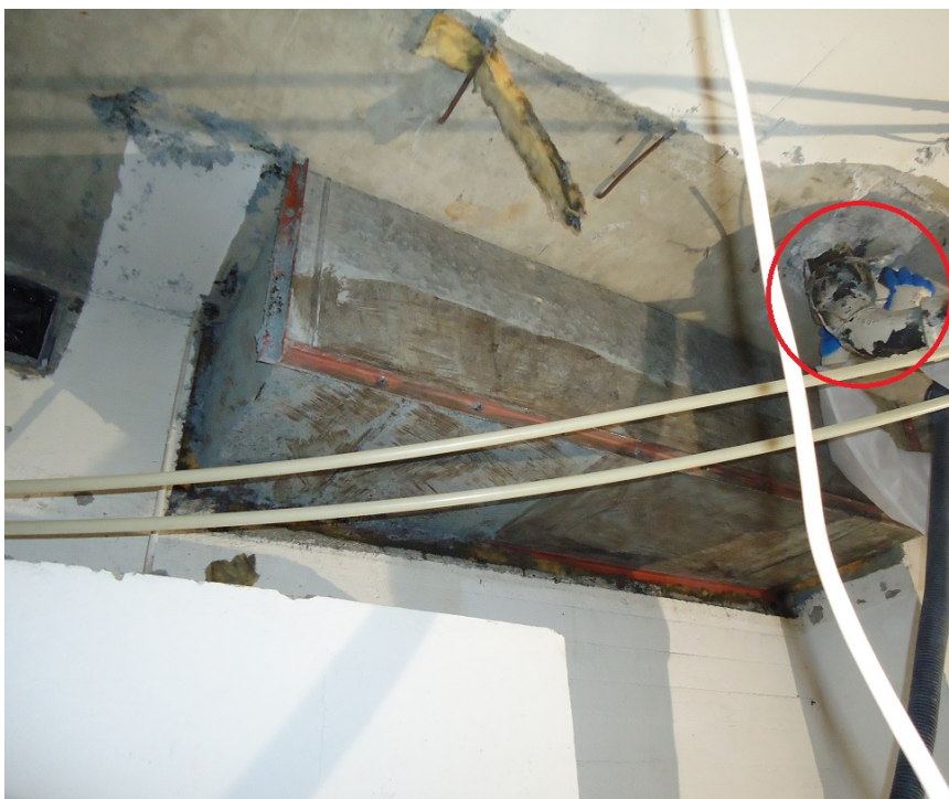
Kuva 29. Isossa ilmastointikanavassa näkyy putsattua ja putsaamatonta aluetta. Kanavat johtavat pankkiholvin katolle, eikä ison kanavan ja katon välissä ole ilmatilaa, joten se on parempi putsata kokonaan kuin sahata pieni pätkä pois. Imurin letkua pidetään lähellä viemäriputkea eli putsattavassa kohdassa.
