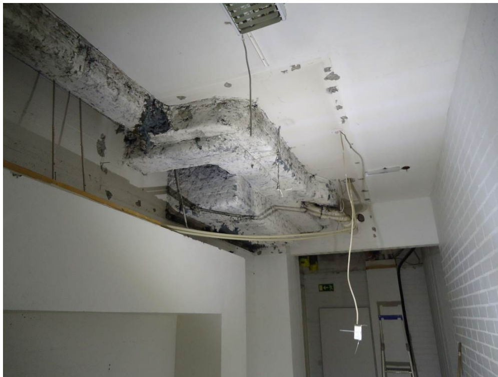
Kuva 26. Alakattojen yläpuolelta paljastui maalattua krokidoliittieristeistä ilmastointikanavaa. Maalauksen ollessa huono, siitä irtoaa asbestikuituja ilmavirtojen mukana.
