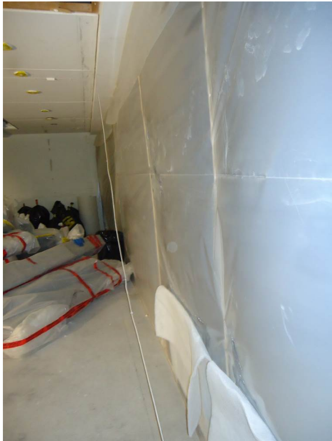
Kuva 17. Silmämääräisesti muoviseiniä katsomalla voidaan todeta osaston olevan alipaineessa. Alipaineistuslaitteet ovat asennettu osaston ulkopuolelle, millä estetään laitteiden pölyntyminen. Osaston alipaineen luomiseen käytetään kahta alipaineistajaa, jotka saavat virtansa eri virtalähteistä.
