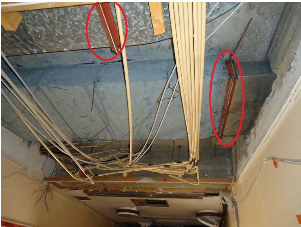
Kuva 12. Valkoista asbestinarua ilmanvaihtokanavien laippaliitoksissa ja sinistä kromidoliittiasbestia toisessa ilmanvaihtokanavassa
