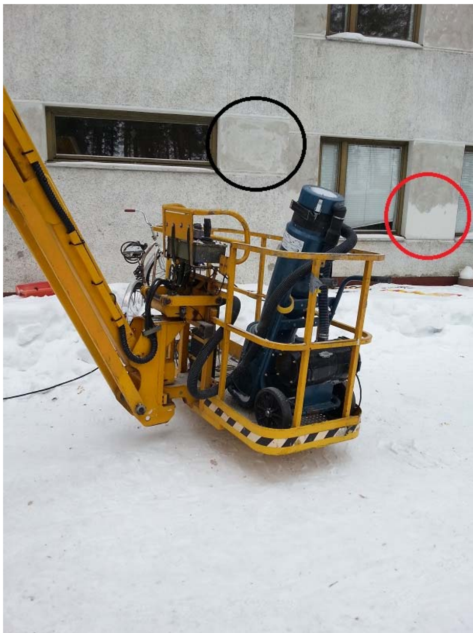
Kuva 15. Kerrostalon ikkunoiden välit sekä pielet ja ovat käsitelty asbestipitoisella maalilla. Mustalla ympyrällä merkitystä kohdasta on asbestipitoinen maali hiottu pois, kun taas punaisella merkityssä kohdassa maalia on vielä hiomatta.
