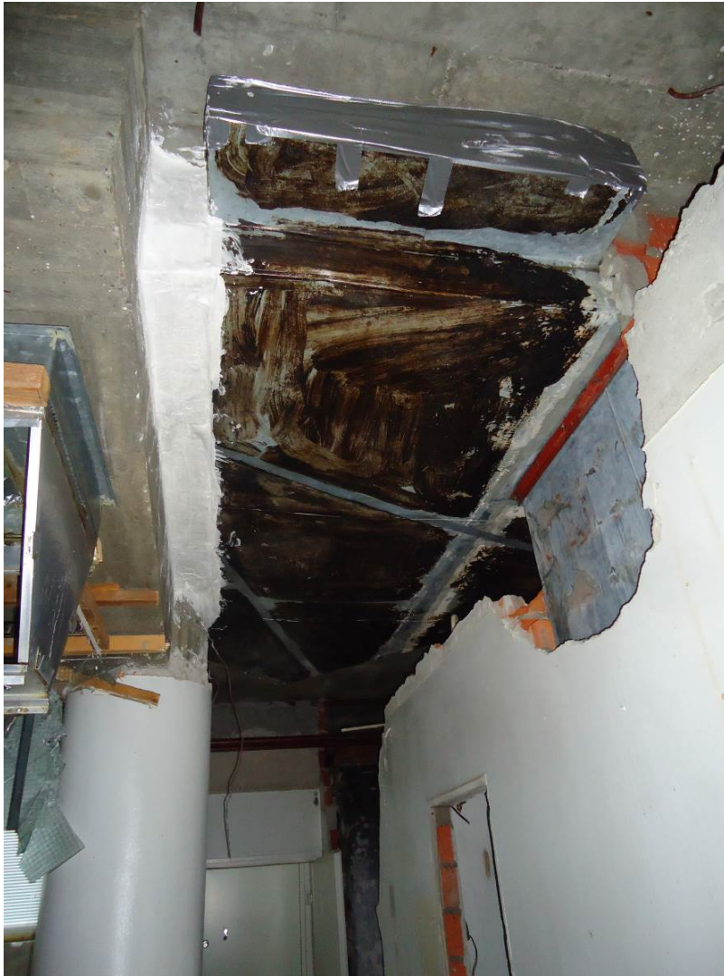
Kuva 31. Säästettävän kanavan yläpuoli ja vierusta kapseloitiin kipsillä joka puolelta niin, että se muodostaa oman ilmatilan eikä se ole yhteydessä muuhun tilan ilmaan.
