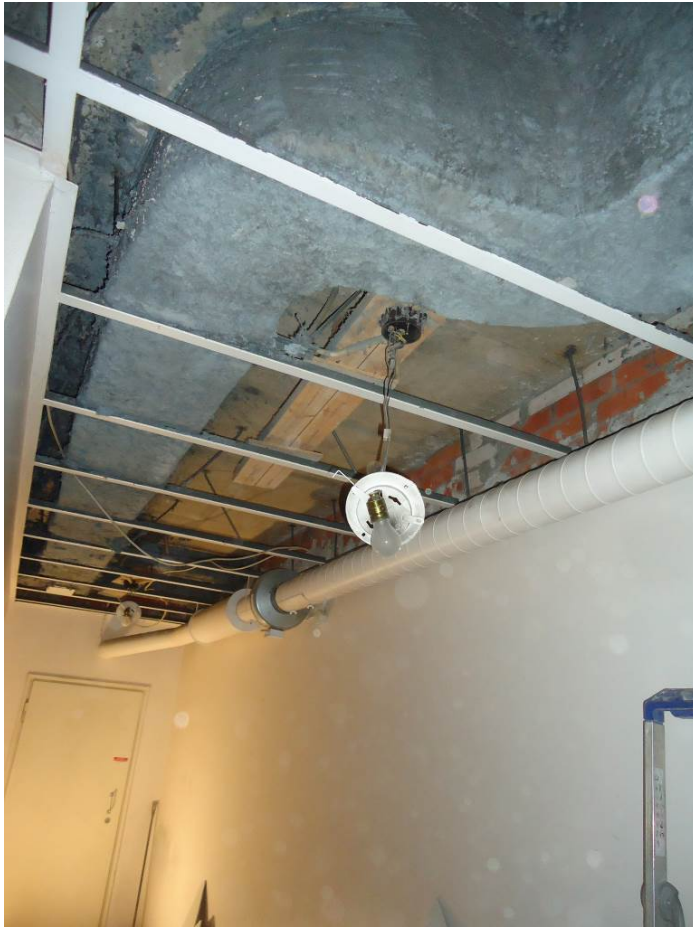
Kuva 9. Ilmastointikanavan asbestiruiskutuksessa on käytetty maalamatonta krokidoliitti-asbestia
