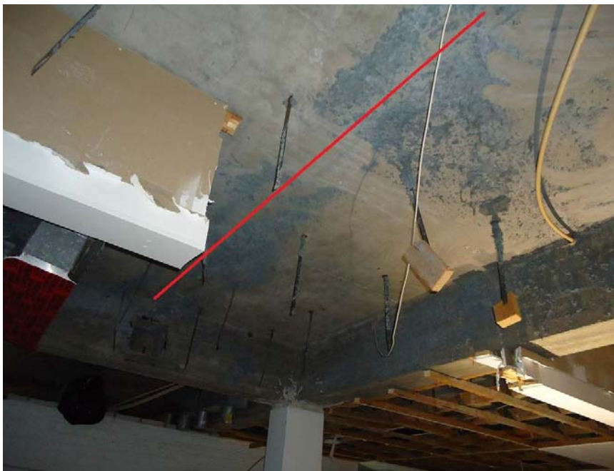
Kuva 28. Kohdassa on mennyt 200x200 mm kokoinen ilmastointikanava suorassa punaisen viivan mukaan läpiviennin läpi, mutta roiskeita oli ympäriinsä palkeissa ja katoissa n. 1,5 metriä kanavan molemmin puolin.
