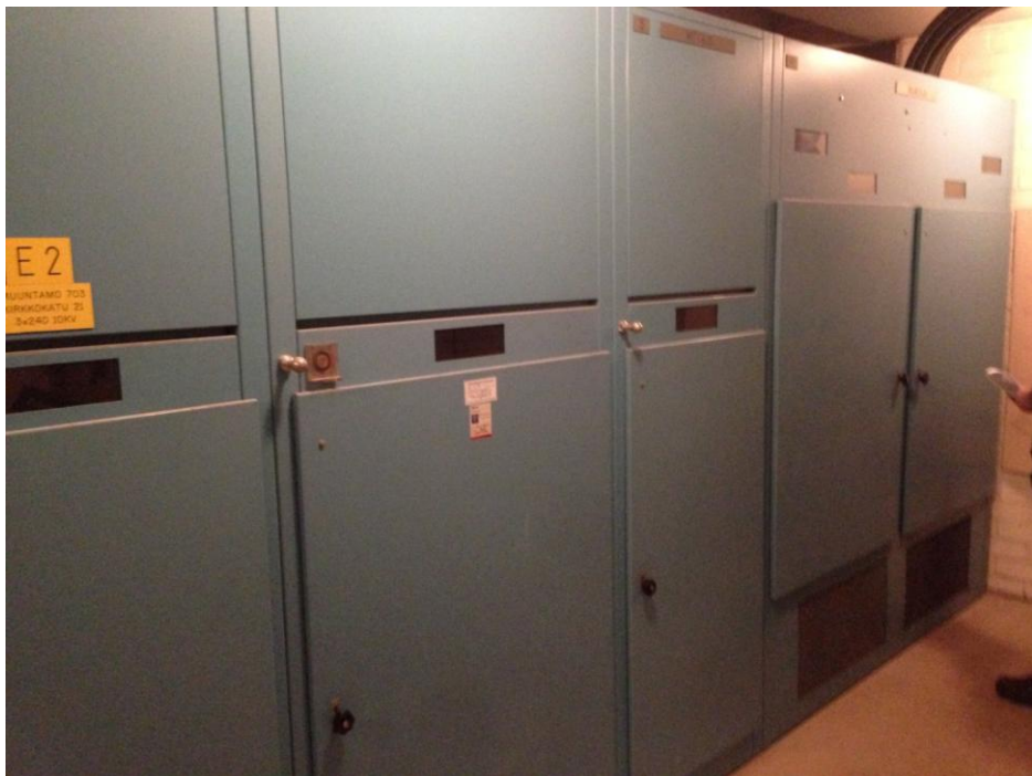
Kuva 1. Suurjännitekojeisto Kiinteistöraha Oy Säästörahassa.
