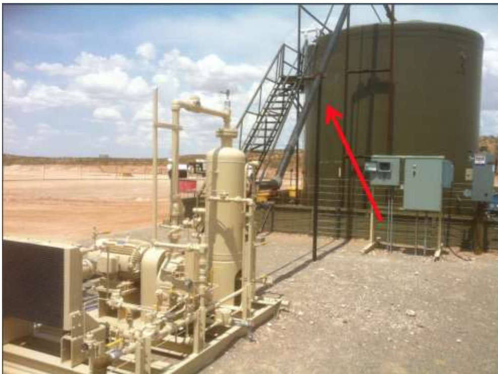
Kuva 3. Keräilyjärjestelmä imee säiliöstä höyrystyvän kaasun talteen. Punainen nuoli osoittaa ylimeno putkea, jonka kautta höyrystyneet hiilivedyt kerätään talteen [19].
