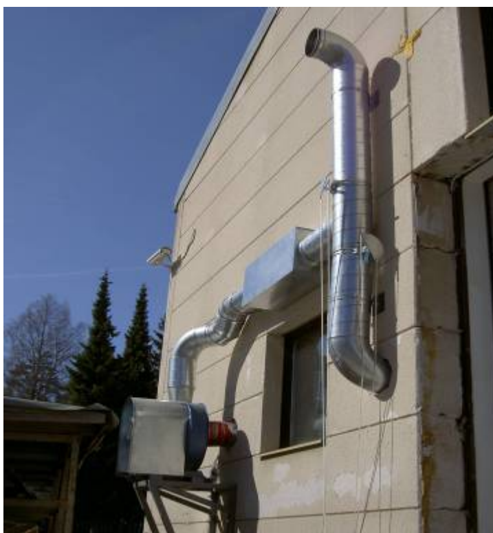
KUVA 19. Imurin ja äänenvaimentimen sijoittuminen päätyseinälle
