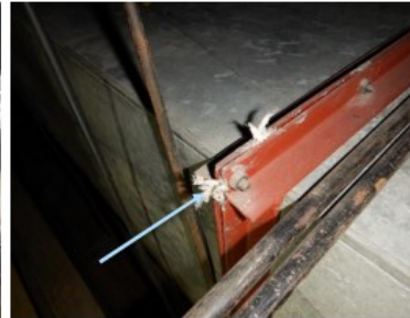
Kuva 4. Punos kanavien liitoksessa
