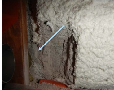
Kuva 6. Valkoisen ruiskupinnoitteen alla harmaa karkea tasoite ei sisällä asbestia, mutta vieressä oleva tumman harmaa hienotasoite (nuoli) sisältää asbestia, näyte AHA 1 ja 6
