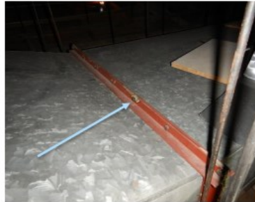
Kuva 3. Ilmanvaihtokanavien liitoksissa käytetty tiivisteenä asbestipunosta
