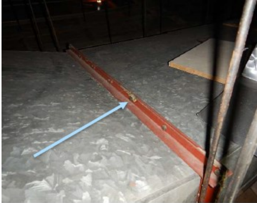
KUVA 8. Asbestipunos ilmanvaihtokanavan saumassa (8)
