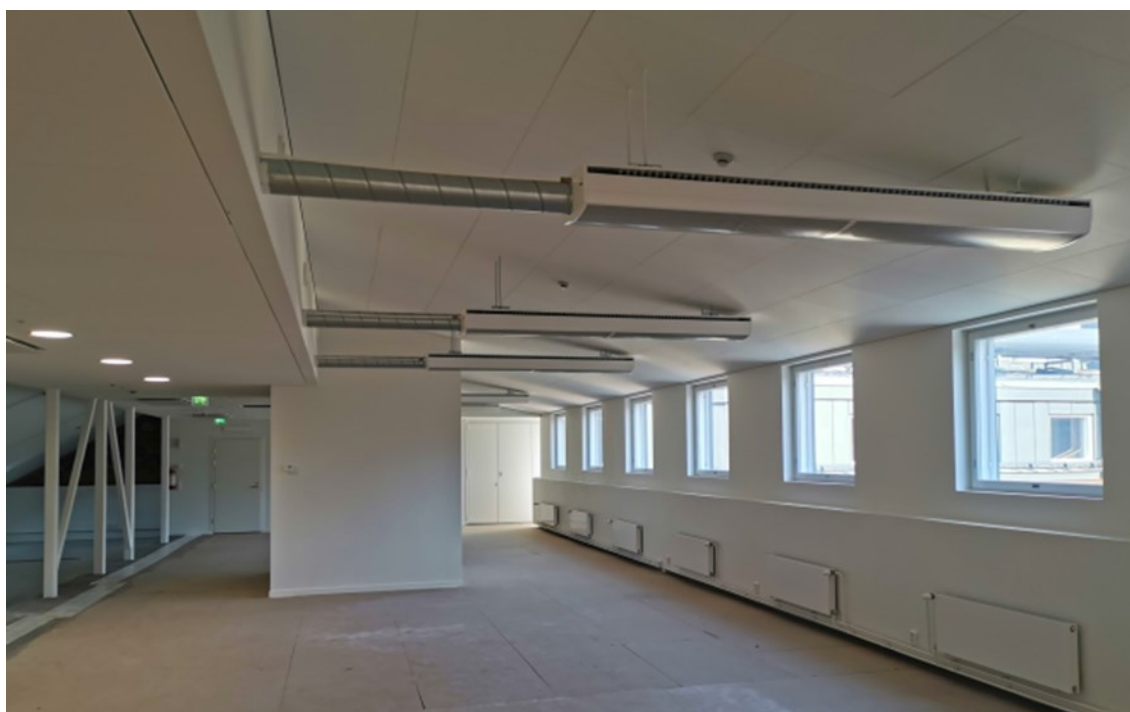
Kuva 14. Kohteeseen asennettuja jäähdytyspalkkeja
