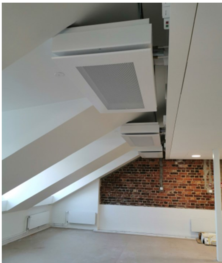
Kuva 13. Kohteeseen asennettu puhallinkonvektori.
