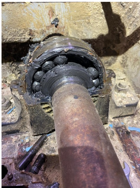
Kuva 14. Vaurioitunut puhaltimen laakeri. (Rossi, 2021)
