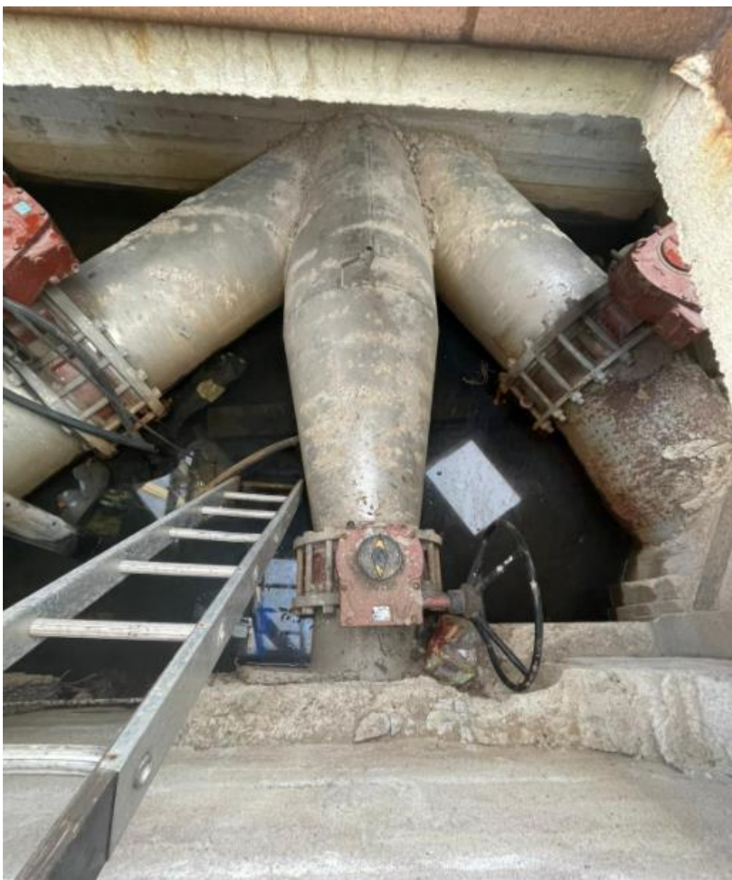
Kuva 7. Venttiilikaivo (Mika Hannuksela, 2021)
