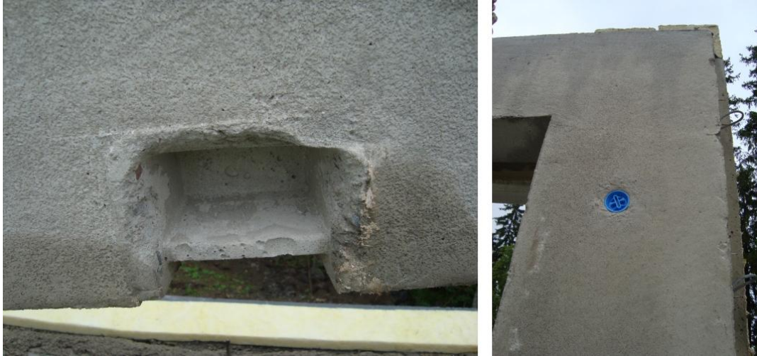
Kuva 2. Asennusta hidastavia laatuvirheitä elementeissä. [Pauli Saastamoinen.]
