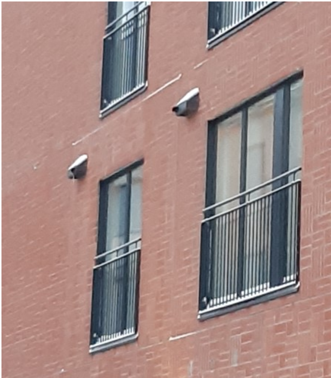
KUVA 1. Vilpe IO -yhdistelmälaitteita kerrostalon ulkoseinässä
