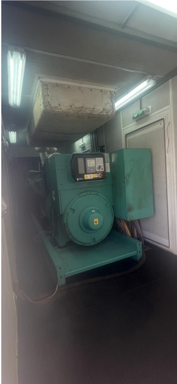
Kuva 6. Somalian aurinkosähköpuiston dieselgeneraattori.
