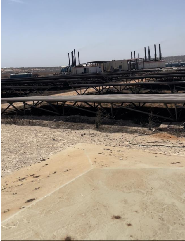
Kuva 7. Kuvassa aurinkosähköpuiston paneeleita ja taustalla näkyy kontteja, joissa sijaitsee inverttereitä ja dieselgeneraattoreita.
