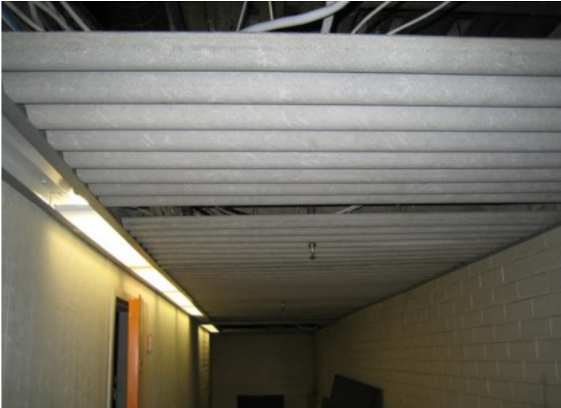
KUVA 2. Asbestipitoinen aaltomainen kuitusementtilevy (11)
