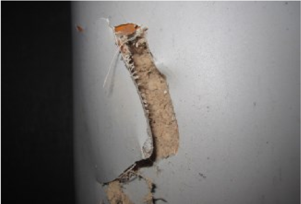
KUVA 3. Asbestipitoinen putkieriste on päällystetty uudella PVC-pinnoitteella (13)
