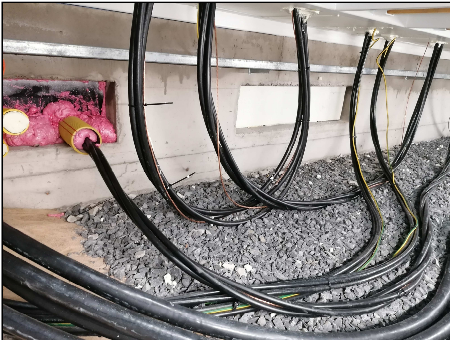
KUVA 31. Kojeistojen väliset kaapeloinnit
