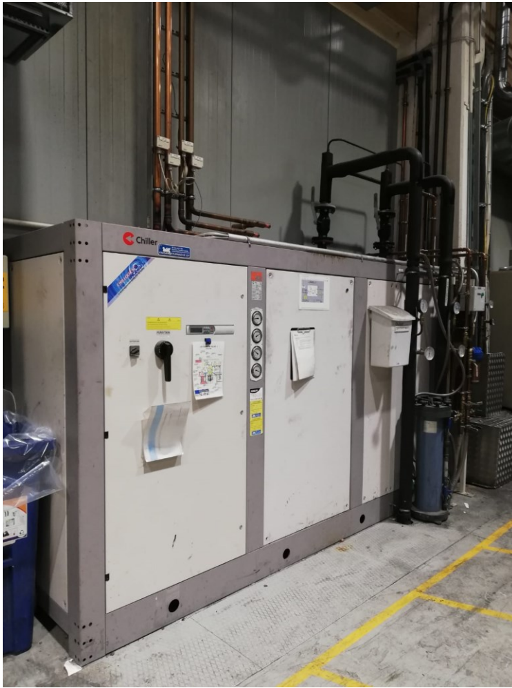
Kuva 18. Chiller merkkinen valukoneiden jäähdytysyksikkö.
