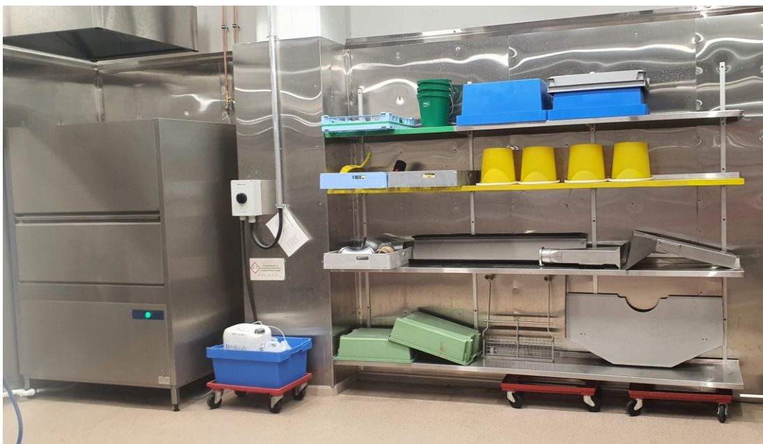
Kuva 6. Laajennetulla ja uudistetulla pesualueella on pesukone ja hyllyt siivous- ja työvälineiden kuivaamiseen ja säilyttämiseen.
