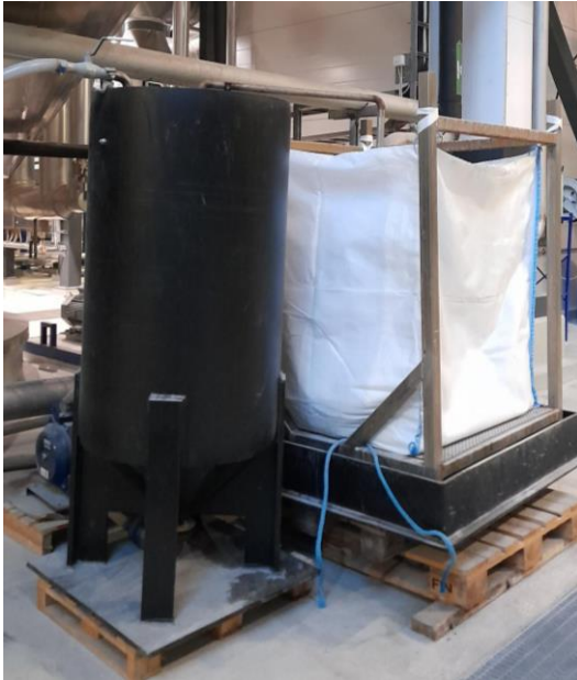
Kuva 13. Vantaan Energian savukaasunkäsittelyalueen kanaalijäteveden esikäsitteilylaitteiston saostusprosessin saostussäiliö ja nesteensuodatussäkki (5 \mu\text{m} ).
