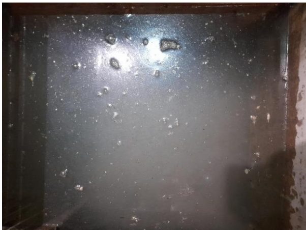
Kuva 6. Sekoitettua kanaalijätevettä Vantaan Energian jätevoimalaitoksen savukaasulauhteen käsittelyalueen kanaalikaivossa.
