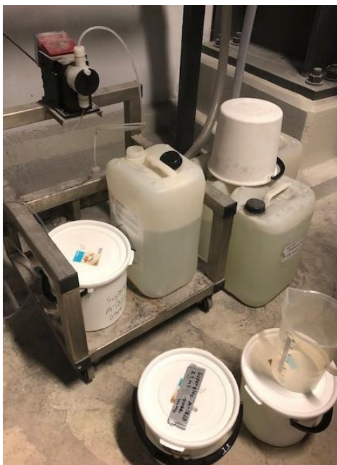
Kuva 12. Vantaan Energian savukaasukäsittelyalueen kanaalijäteveden esikäsitteilylaitteiston saostuskemikaalin pumppausyhde.
