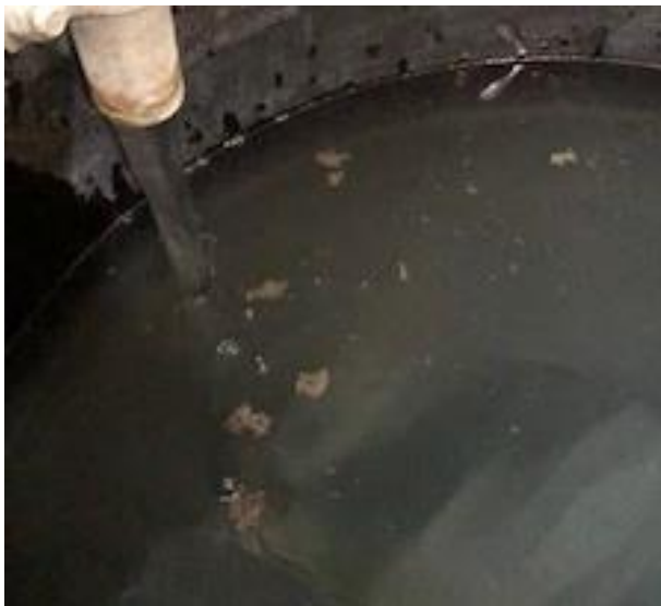
Kuva 19. Vantaan Energian savukaasulauhteen käsittelyalueen kanaalijäteveden esikäsittelylaitteiston koeajon aikana saostussäiliön pinnalle muodostunutta saostumaa.
