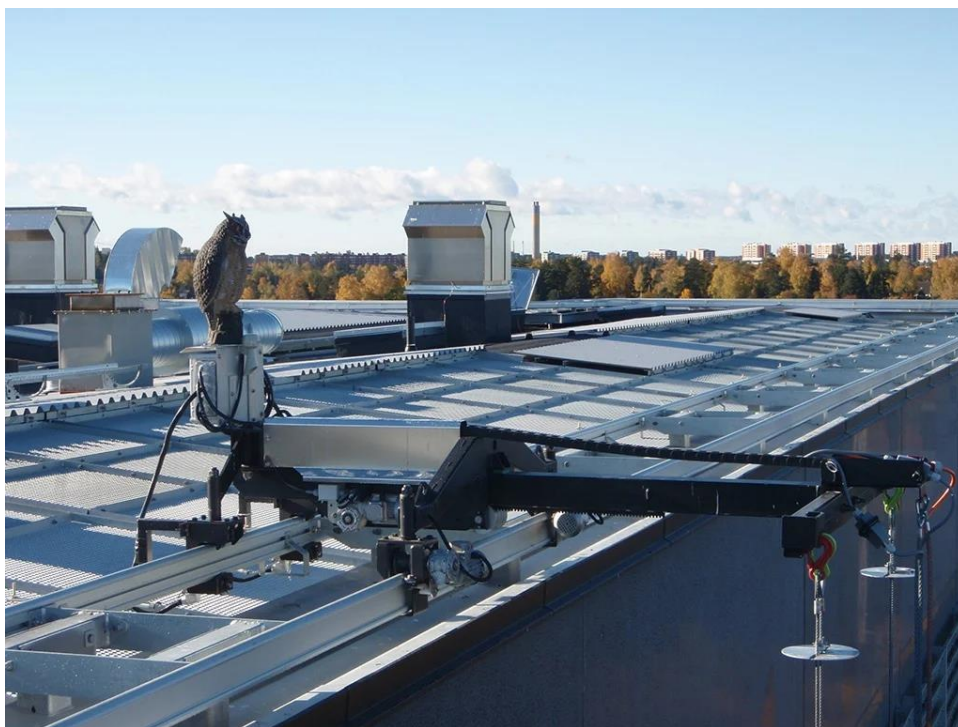
Kuva 4. Julkisivun huoltokelkka (Rostek)
