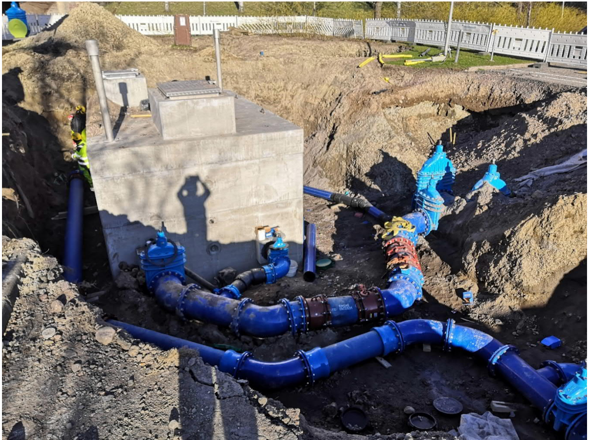
Kuva 9. Kaivoksela-Myyrmäki runkovesijohdon rakentaminen urakka. Virtausmittauskaivon putkien asennus. DN200 ja DN400 Sg-vesijohdot (Kemppainen 2020)
