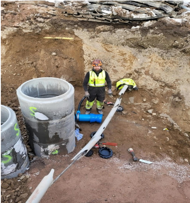
Kuva 8. DN200 Sg-putki, jossa 11° muhvikulmayhde ja tonttihaara. (Kemppainen 2022)
