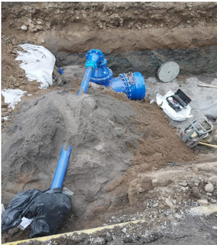
Kuva 6. T-haara, jossa ilmauskaivolle haara otettu ylöspäin ja DN600 E-kappale. (Kemppainen 2020)
