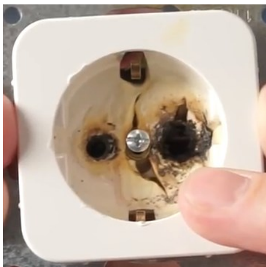
Kuva 5. Vaurioitunut kotitalouspistorasia (Niemi 2019).
