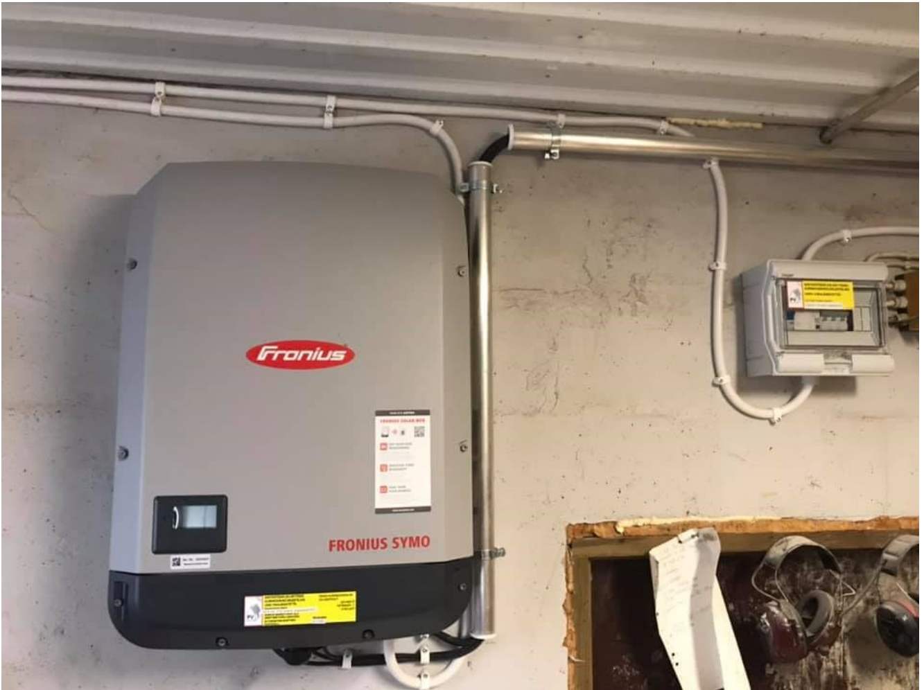
Kuva 6. Invertterin asennus (Kari Hemminki)
