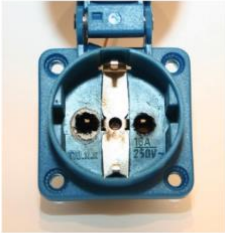
KUVA 8. Sähköauton latauksen aiheuttaman ylikuormituksen tuhoama kotitalouspistorasia (3, s. 32)
