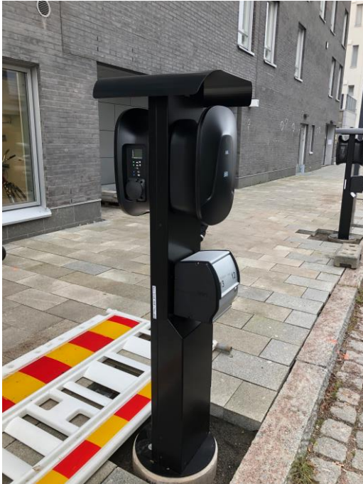
KUVA 24. Latausasemat ja autolämmityspistorasiakotelo kiinnitettyinä samaan pylvääseen
