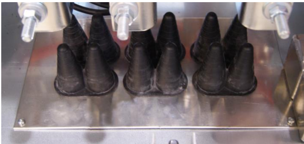
Kuvio 15. Generaattorikentän lattialäpivienti asiakkaan liityntäkaapeleille.
