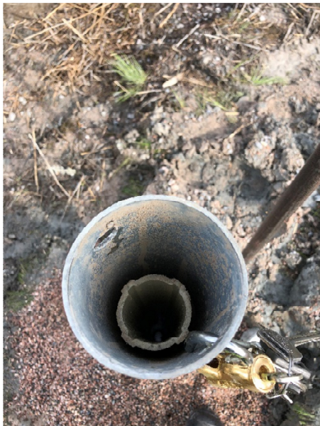
Kuva 2. Inklinometriputki ja vandaaliputki
