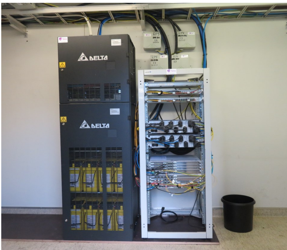
Kuva 3. Delta 17,4 kW:n kuusimoduulinen kaappimallin tasasuuntaaja varustet- tuna kahdella akustolla. kuvassa vasemmanpuoleinen kaappi.
