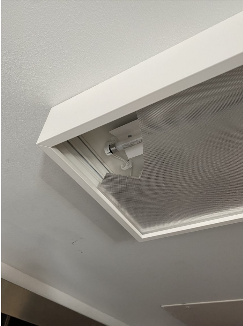
Kuva 5. Esimerkki rikkoutuneesta valaisimen häikäisysuojasta. [7.]
