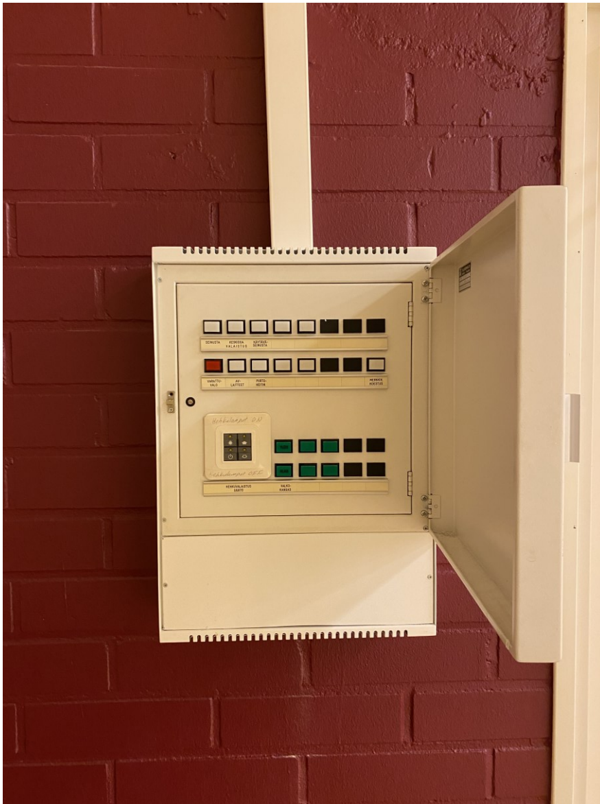
Kuva 6. Esimerkki vanhasta valaistuksenohjauskeskuksesta. [7.]
