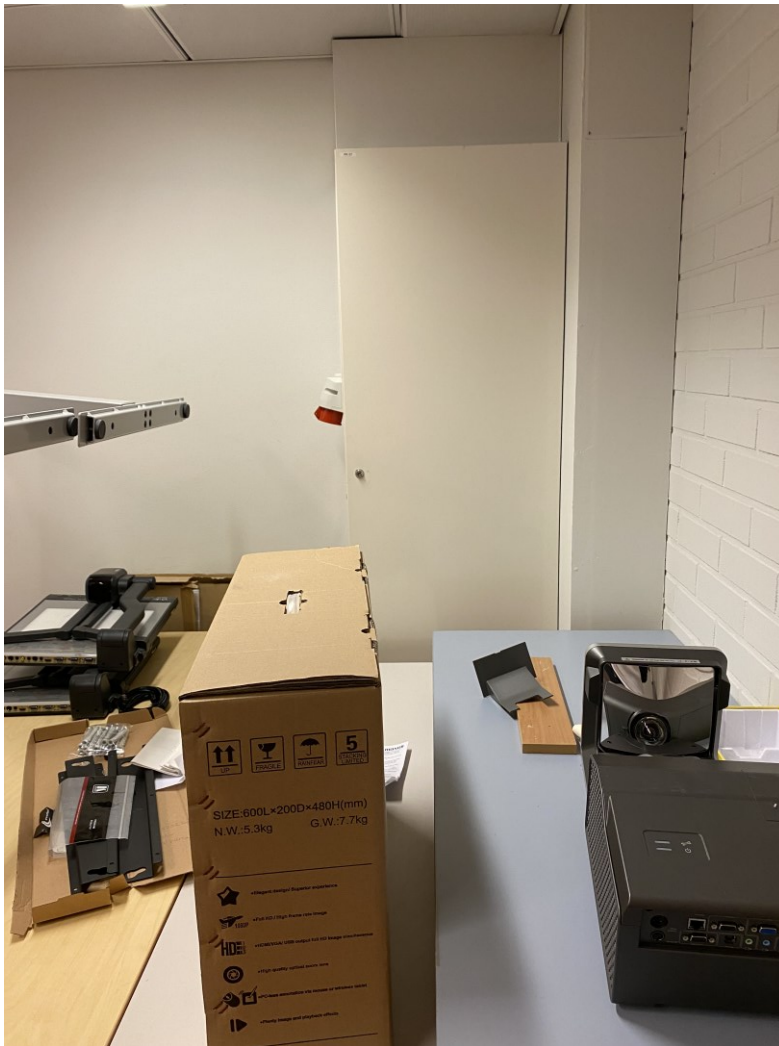
Kuva 3. Keskuksen edessä tavaroita, jotka estävät esteettömän pääsyn keskukselle. [7.]
