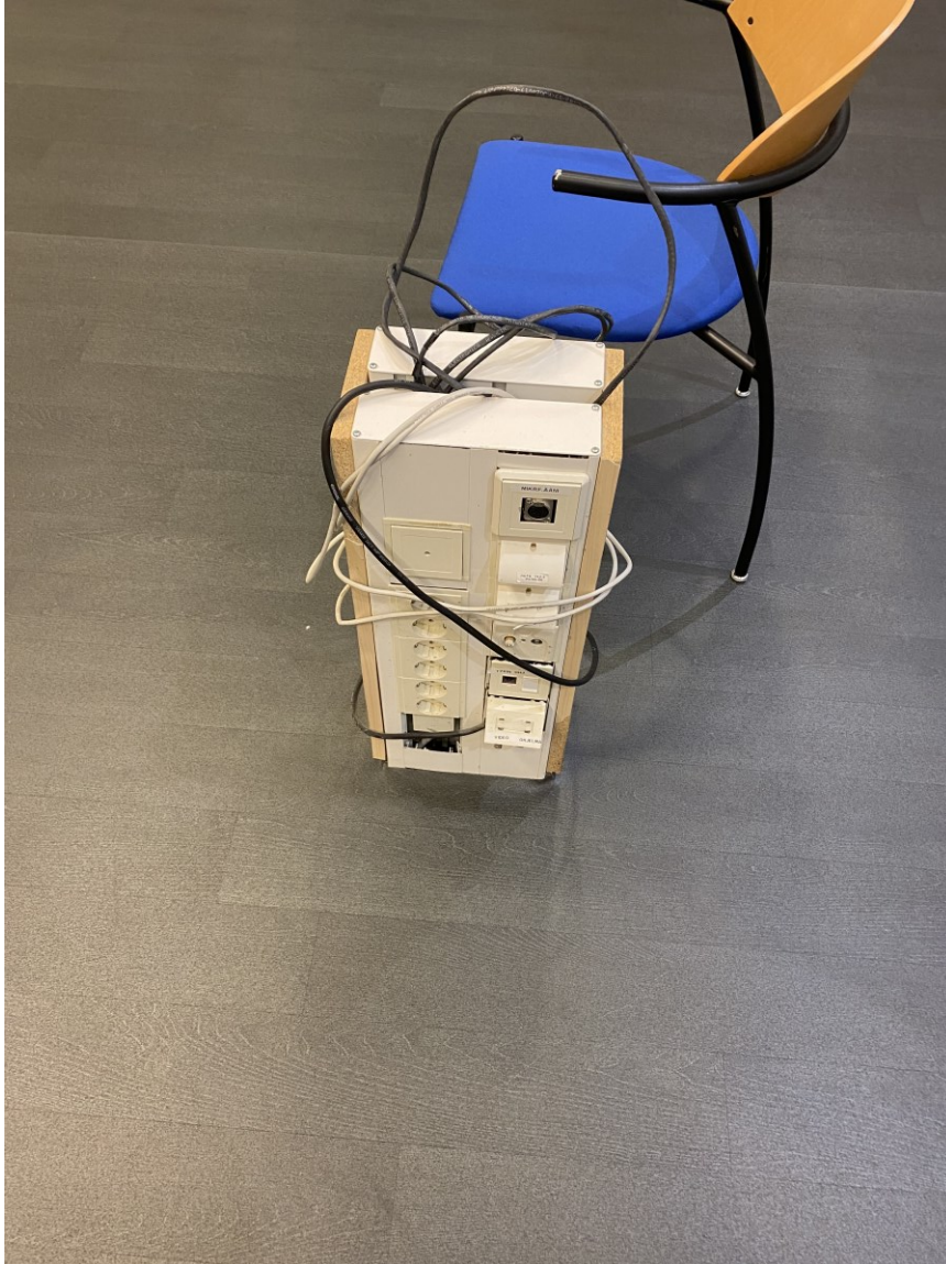
Kuva 7. Esimerkki puutteellisesta kosketus suojauksesta ja sotkuisesta johdotuksesta. [7.]
