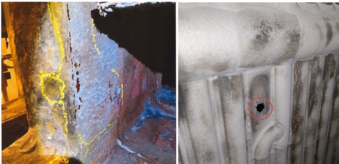
Figur 11. Skador orsakade av korrosion i rökgasrening och panna. (Laatutesti Oy, 2018, 2020).
