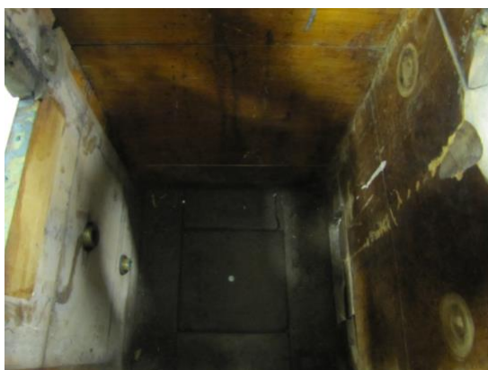
Kuva 24 Pumpun sisäosa koneiston irrottamisen jälkeen (Ikonen 2022)
