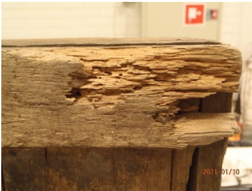
Kuva 71 Lähikuva hyönteisvauriosta alaosan jalaksessa (Ikonen 2022)
