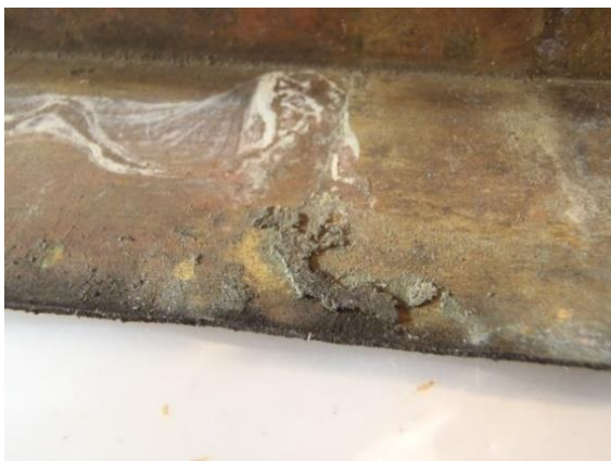
Kuva 66 Kulmarauta ennen puhdistusta (Ikonen 2022)
