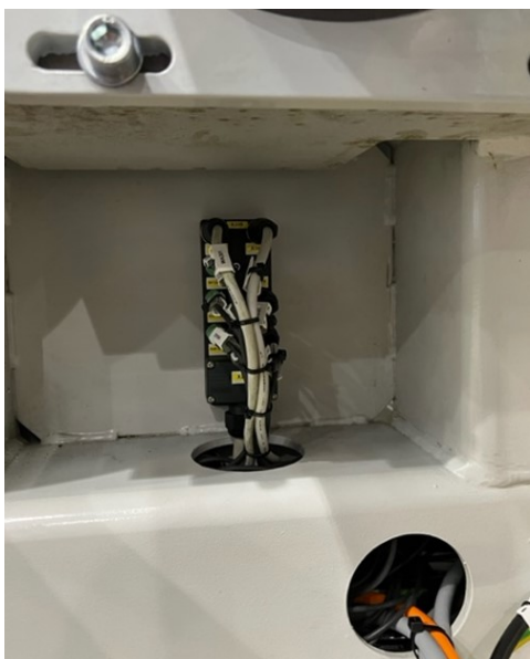
Kuva 9. X200-toimilaitemoduuli rungon takaosassa (=TU1+A1)
