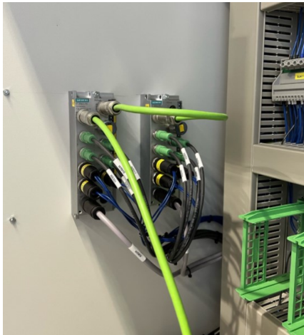
Kuva 27. ET 200eco PN F-DI/F-DQ-moduulit linjaohjauskeskuksen (=LC1+A2) seinällä.
