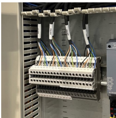
Kuva 28. Riviliitin X20 linjaohjauskeskuksessa (=LC1+A2).
