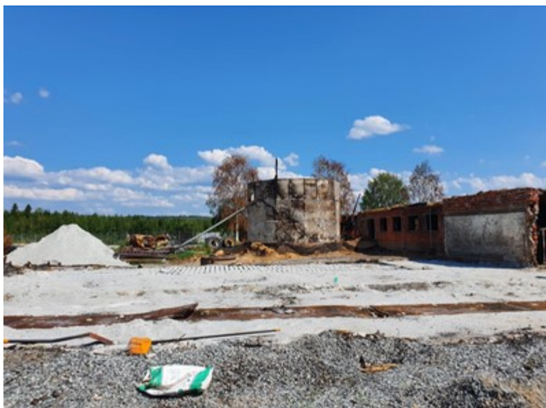
KUVA 9. Kalkittu navetan pohja, josta ei muuta palossa jäänyt jäljelle (Karjalainen 2021)
